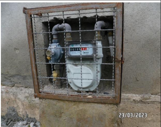
Se observa que el medidor tiene un registro de 196 m3.
