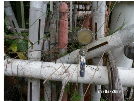
Se observa el estado actual de manómetro en el área de control de presión.
