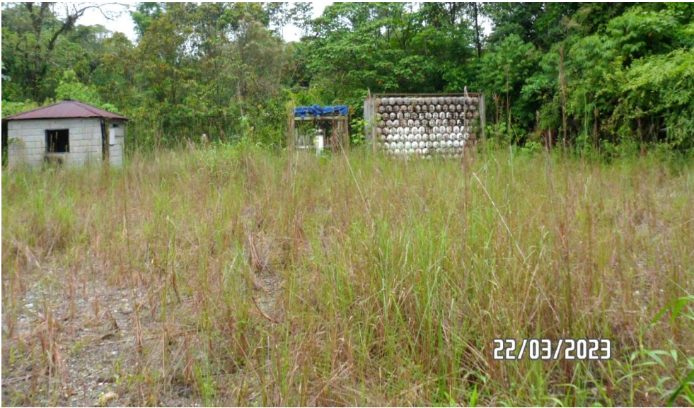
Vista general de la estación descompresora de gas natural, observándose abandono y falta de mantenimiento en general.
