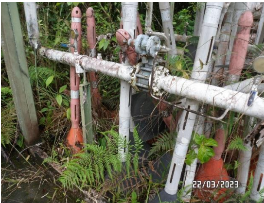
Se observa la maleza que se encuentra dentro de área de distribución y control de presiones del sistema.
