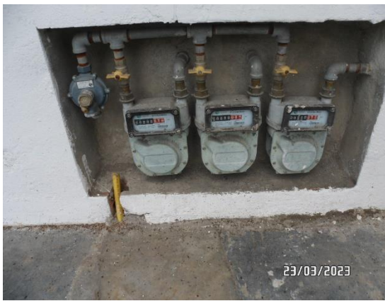
Vista de contadores instalados a las redes internas pero que no se conectaron a la acometida.
