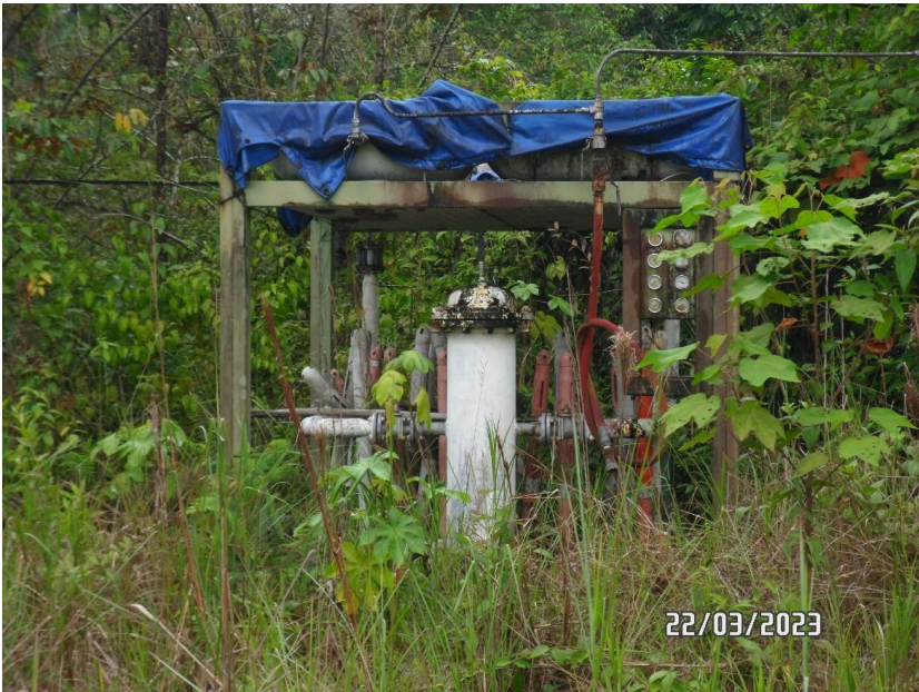
Area de control de recargue de gas y de descompresión que se encuentra con signos de oxidación y con maleza. Se observa que algunos manómetros marcan presión pero se desconoce si los tanques tienen gas o los mismos se encuentran dañados o descalibrados
