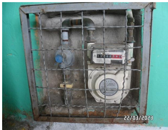
Contador debidamente instalado
