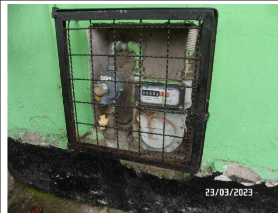
Se observa medidor de gas debidamente instalado y con un registro de 64 m3, evidenciándose que en algún momento se prestó el servicio
