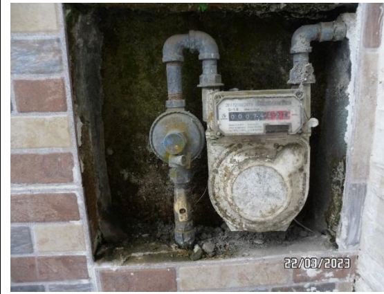
Contador instalado con medida de consumo de 74 m3 de gas
