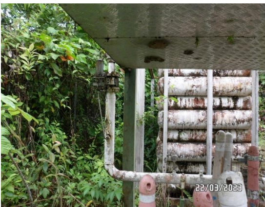
Vista lateral de los tanques de almacenamiento del sistema de gas natural.
