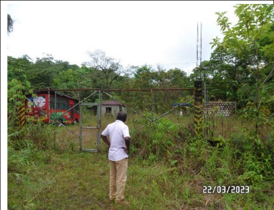
La estación descompresora de gas posee cerramiento, pero se puede acceder sin ningún problema a su interior. Se observa la maleza alta.
