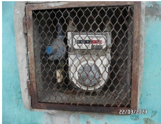
Contador instalado con consumo mayor de 100 m3 de gas
