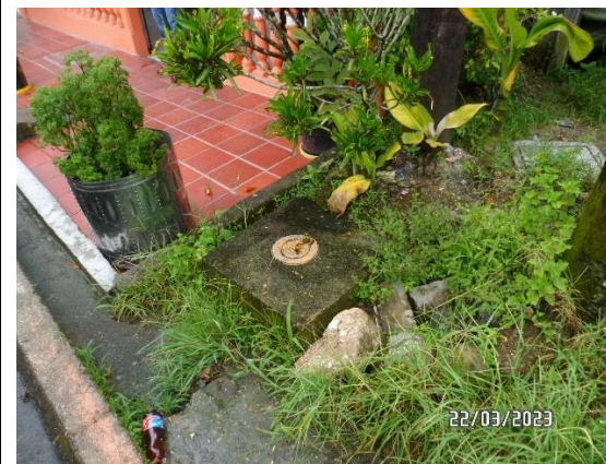
Se evidencia ubicación de válvula de registro
