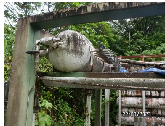
Tanque de distribución de gas con grado de deterioro y expuesto a las condiciones climáticas del Chocó.
