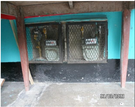
Otro grupo de contadores que muestran consumos de 76 m3 y 214 m3. También se observa la reparación del andén
