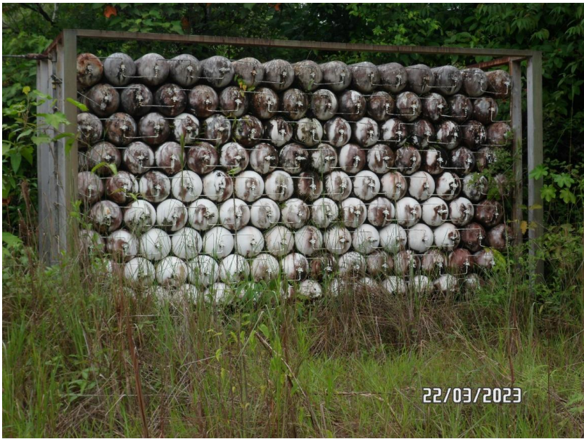
Vista del estado actual de la plataforma de almacenamiento del gas en la estación descompresora. Los tanques se encuentran a la interperie con alto grado de oxidación y cubiertos de maleza.
