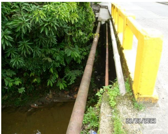
Cruce de quebrada donde se observa, de izquierda a derecha, tubería metálica que protege la red de gas de 4”, la red de distribución de 2” y línea de agua potable.
