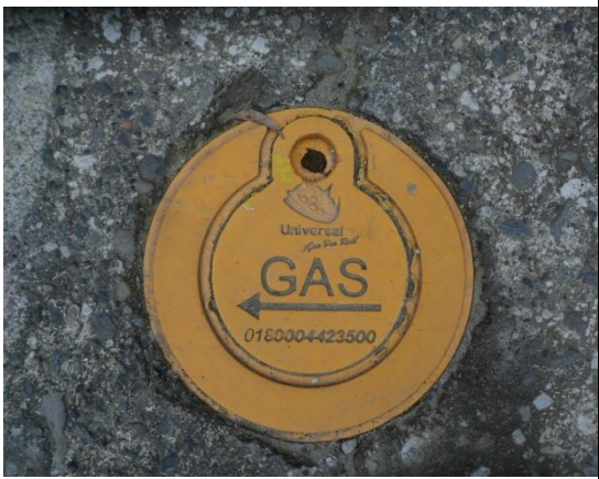
En el recorrido por el municipio se encuentran las válvulas de registro, control o cierre de la red de distribución.
