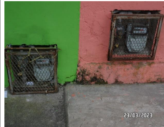
Instalación de registros de gas con su acometida e instalación interna. Los contadores muestran consumo de gas.
