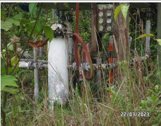
Vista del área de control de la presión del sistema. Se observa la manguera (roja) que sirva para descargar el gas. La válvula de control estaba en posición abierta.
