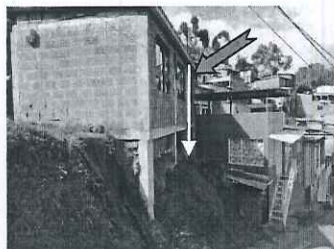
CUBIERTA SIN BAJANTES. Foto #2
