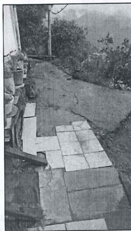
Foto 1: Hall de acceso a la vivienda con fisuras y bombeo hacia el talud
