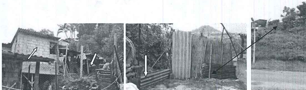
Tejados sin manejo de aguas adecuados
