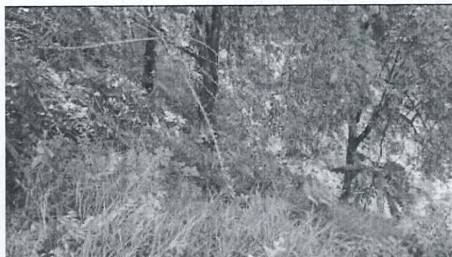
Figura 3: Ladera adyacente al hundimiento de la vía por donde descola las aguas lluvias. Al momento no evidencia ningún tipo de inestabilidad
