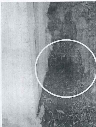
Talud contiguo a uno de los muros, donde se presentan afloramientos de aguas
