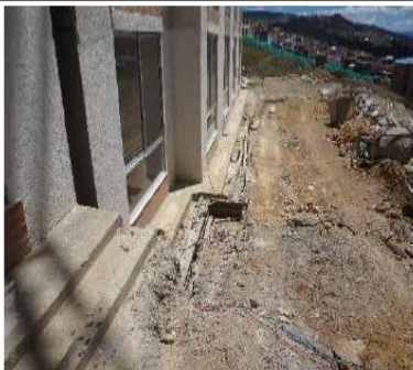
Comentarios: Vista de la fachada posterior de la torre G bloques 4 y 5, donde se observa que no se han terminado las obras de cunetas o cañuela en concreto para manejo de aguas, actividad pendiente desde la visita de supervisión realizada el 16 de abril de 2015.
