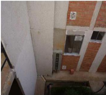
Comentarios: Vista exterior de la fachada entre los bloques 4, 5 y 6, donde se observa un área de muro en el primer piso junto al gabinete metálico, donde no se ha aplicado graniplas, actividad pendiente desde la visita de supervisión realizada el 16 de abril de 2015.
