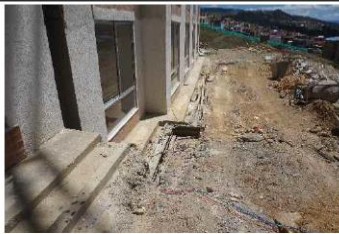
Comentarios: Vista de la fachada posterior de la torre G bloques 4 y 5, donde se observa que no se han terminado las obras de cunetas o cañuela en concreto para manejo de aguas, actividad pendiente desde la visita de supervisión realizada el 16 de abril de 2015.
