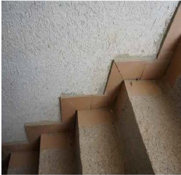
Comentarios: Vista del área de punto fijo de los bloques 7 y 8 torre G, donde se observa que a la fecha no se ha realizado el llenado de juntas en la tableta de piso y guarda escoba instalado.
