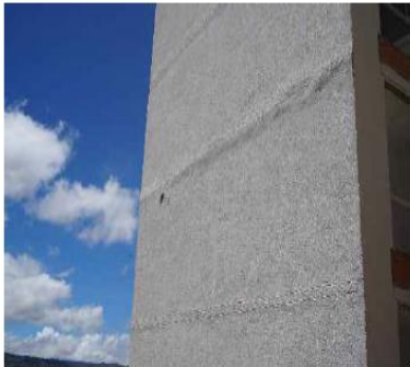
Comentarios: Fachada lateral del bloque 6 torre G, donde se observa una fractura o perforación en el muro, la cual no se ha corregido, actividad pendiente desde la visita de supervisión realizada el 16 de abril de 2015.
