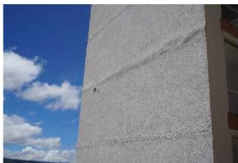
Comentarios: Fachada lateral del bloque 6 torre G, donde se observa una fractura o perforación en el muro, la cual no se ha corregido, actividad pendiente desde la visita de supervisión realizada el 16 de abril de 2015.
