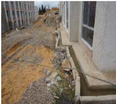
Comentarios: Vista fachada posterior apartamento 102 Bloque 6 Torre G, donde se observan actividades pendientes en mejorar cunetas y bordillos en concreto para evacuación de escorrentías.
