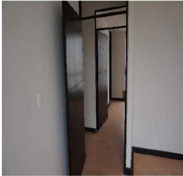
Comentarios: Vista interna de apartamento localizado en el bloque 8 torre G, donde se observa que está pendiente la instalación de chapas de seguridad para puertas.
