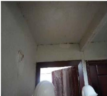
Comentarios: Vista del dintel localizado sobre la puerta principal del apartamento 101 Bloque 5 Torre G, con actividades pendientes de rematar dilataciones.
