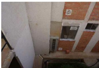
Comentarios: Vista exterior de la fachada entre los bloques 4, 5 y 6, donde se observa un área de muro en el primer piso junto al gabinete metálico, donde no se ha aplicado graniplas, actividad pendiente desde la visita de supervisión realizada el 16 de abril de 2015.
