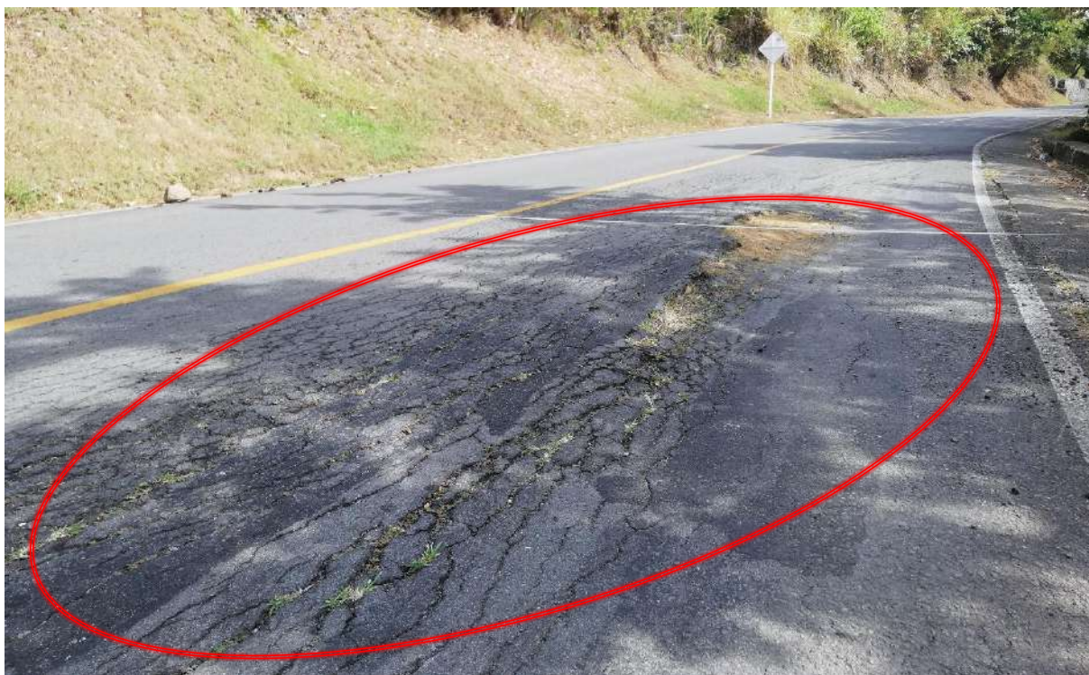
Fotografía N° 6: En esta imagen en sentido El Bordo-Bolívar, se observa el ovalo de color rojo donde se aprecia la dimensión del hueco y los daños que se encuentran en la carpeta asfáltica de rodado, sobre el carril en sentido Bolívar-El Bordo Cauca
