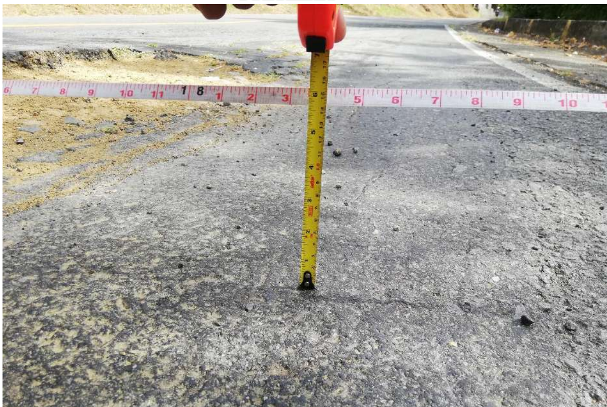
Fotografía N° 7: En esta imagen en sentido El Bordo-Bolívar, se observa la profundidad del hueco presente en la vía que es de 14 centímetros
