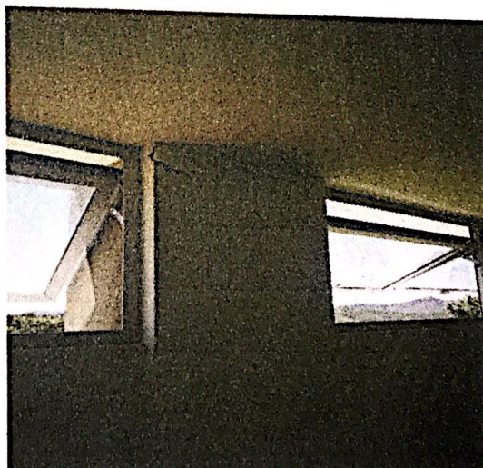
Ilustración 8. Pañetes en mal estado.
