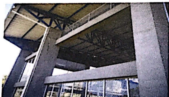
Ilustración 3. Caída de ventanal Superior
