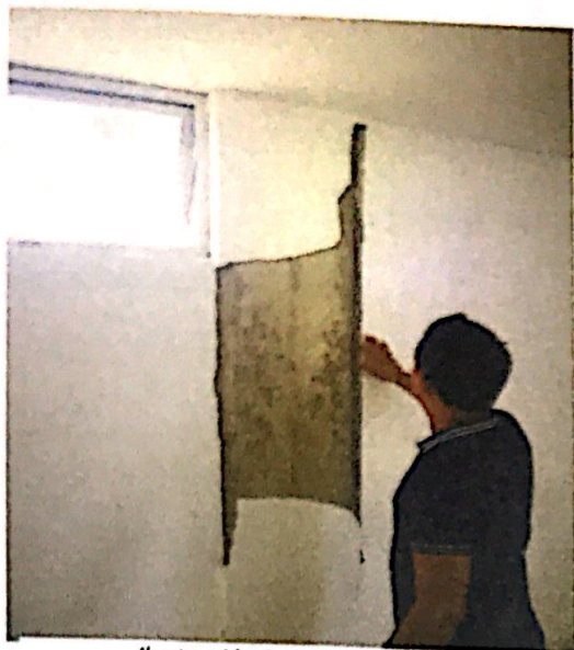
Ilustración 9. Daño del pañete.
