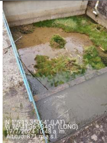
Imagen 118 Filtros de grava y arena.
