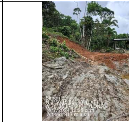
Imagen 94 Tubería rota por construcción de piscinas – Sector Simón Bolívar.
