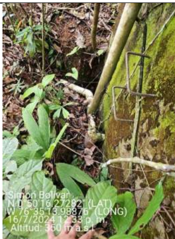
Imagen 90 Tubería de entrada Tanque Simón Bolívar.
