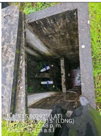
Imagen 29 Cámara de salida –PTAP.
