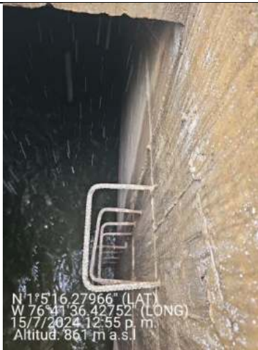
Imagen 35 Tanque PTAP con agua.
