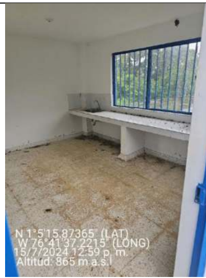
Imagen 42 Cuarto de cloración.
