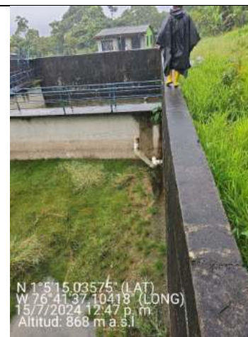
Imagen 30 Filtros de arena y grava con material vegetal PTAP.
