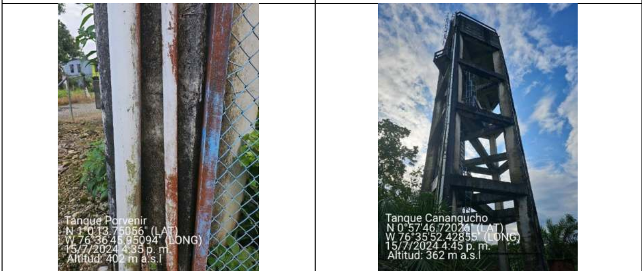
Imagen 71 Tubería de salida tanque Porvenir.
