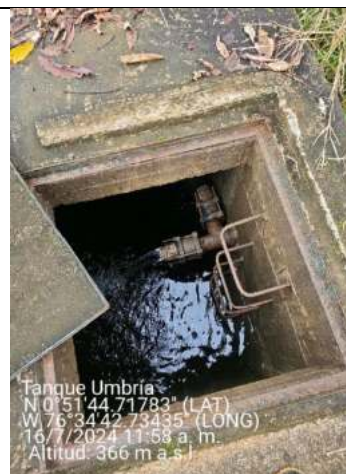
Imagen 83 Evidencia de suministro de agua al tanque Umbría.
