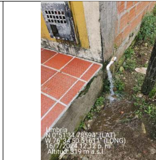
Imagen 92 Evidencia suministro de agua sector Umbria.
