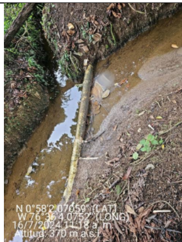
Imagen 121 Conexiones ilegales (2) a la red matriz del macroacueducto.
