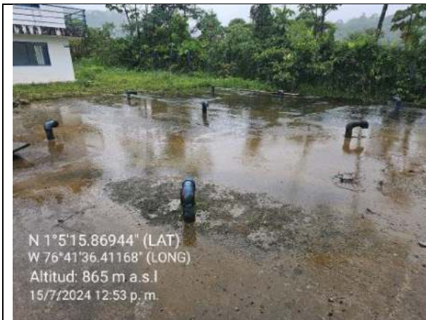
Imagen 37 Vista superior, Tanque PTAP con tubería de aireación.
