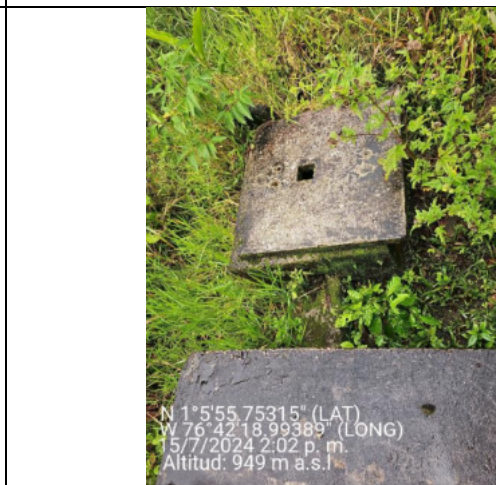
Imagen 52 Caja válvula de corte desarenador.
