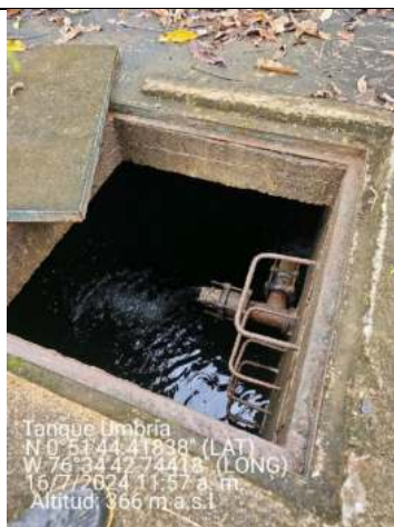
Imagen 82 Evidencia de suministro de agua al tanque Umbría.
