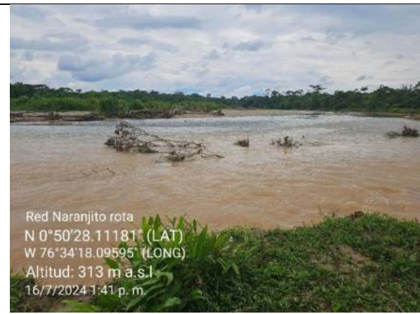
Imagen 110 Derivación sector Naranjito afectada por movimiento de cauce del río.
