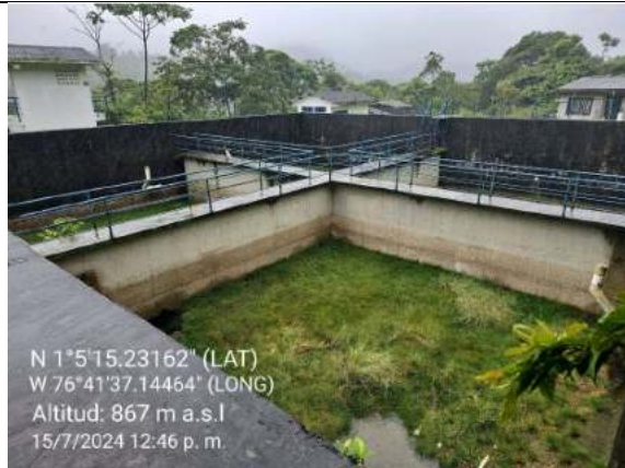
Imagen 31 Filtros de arena y grava con material vegetal PTAP.
