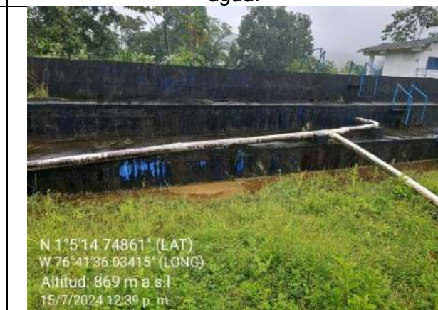
Imagen 24 Tubería desacoplada – planta de tratamiento de agua.
