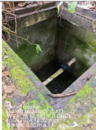
Imagen 89 Válvula de corte tanque Simón Bolívar.
