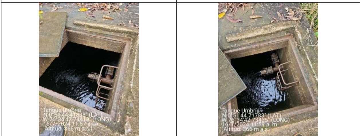
Imagen 87 Evidencia de suministro de agua al tanque Umbría.
