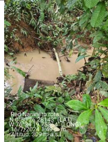
Imagen 112 Derivación sector Naranjito afectada por movimiento de cauce del río.
