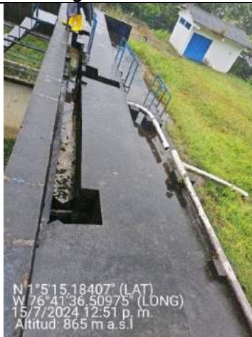
Imagen 27 Canal de salida PTAP.
