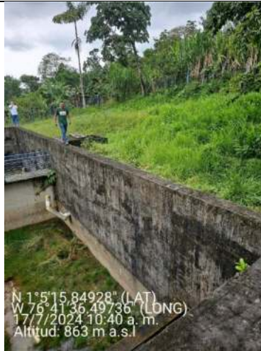
Imagen 117 Filtros de grava y arena.
