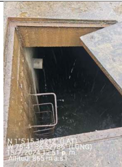
Imagen 26 Tanque de almacenamiento planta de tratamiento.
