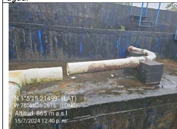
Imagen 23 Tubería desacoplada – planta de tratamiento de agua.
