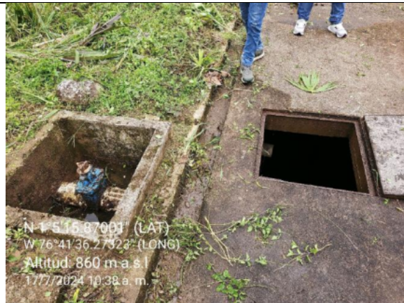
Imagen 115 Válvulas de corte, cajas y compuertas PTAP.
