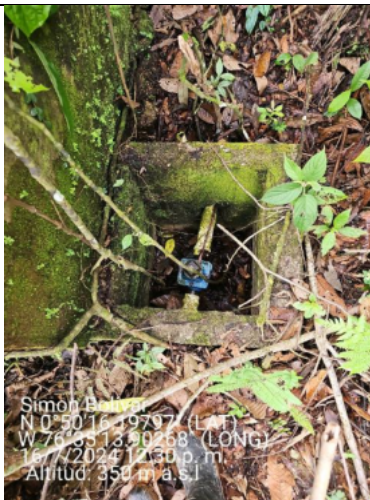
Imagen 88 Válvula de corte tanque Simón Bolívar.
