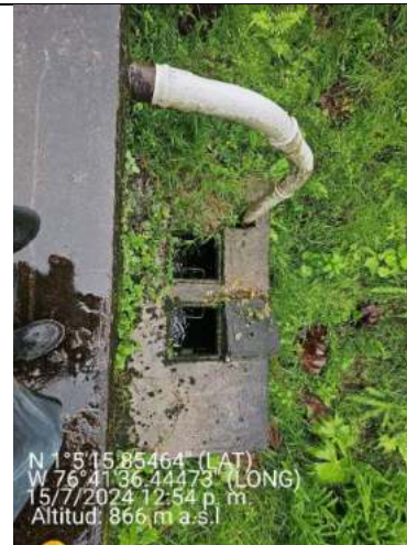
Imagen 36 Tubería de entrada PTAP.
