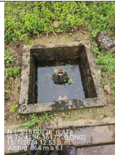
Imagen 38 Válvula de corte PTAP.
