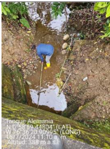
Imagen 120 Conexiones ilegales (3) a la red matriz del macroacueducto.
