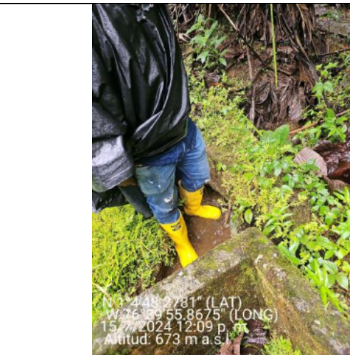
Imagen 10 Válvula de purga.
