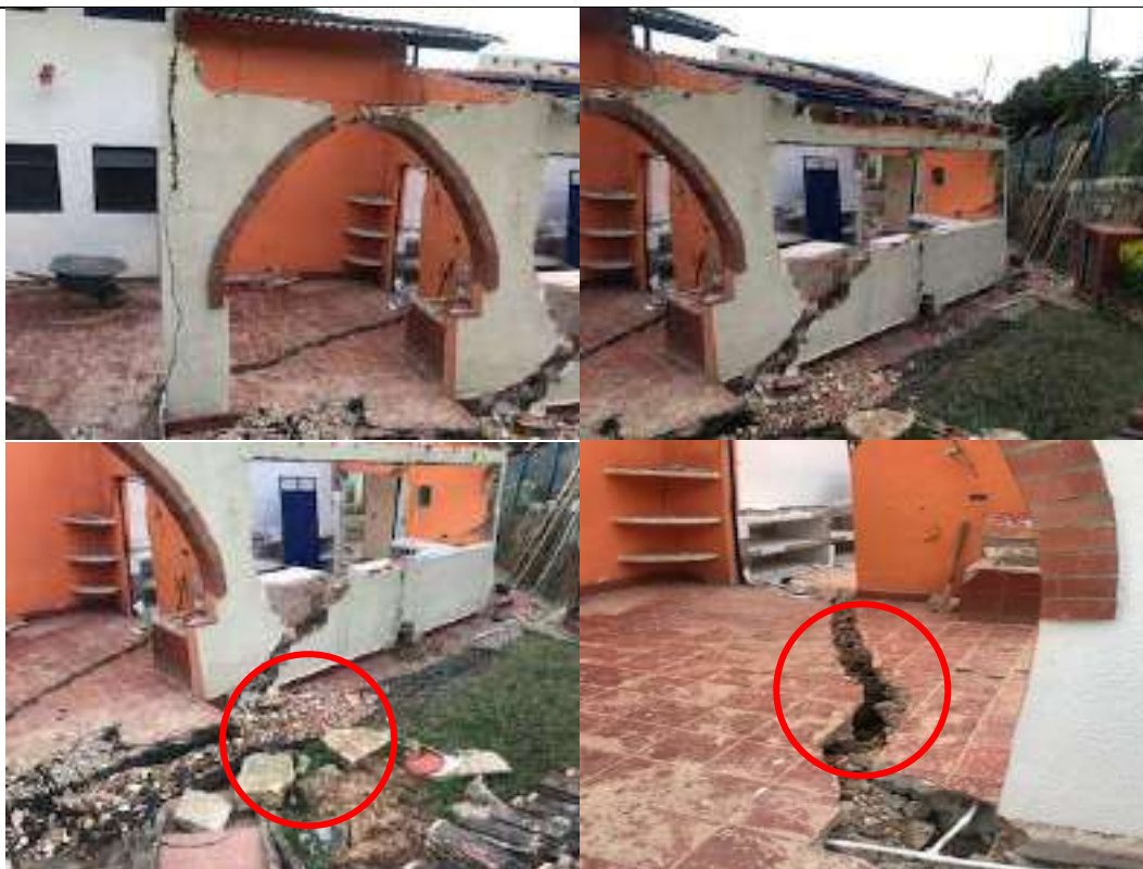
Agrietamientos en la vivienda colapsada, lote 4, filtro perimetral a la estructura.
