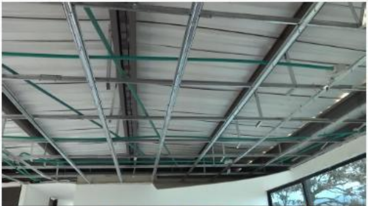
Foto No 7: Estado de cielo rasos con las láminas caídas de sus soportes en aluminio anclados a los muros en Superboard. La cubierta apoyada sobre perfiles metálicos permanece en su lugar, aunque no se descartan movimientos en la misma.
