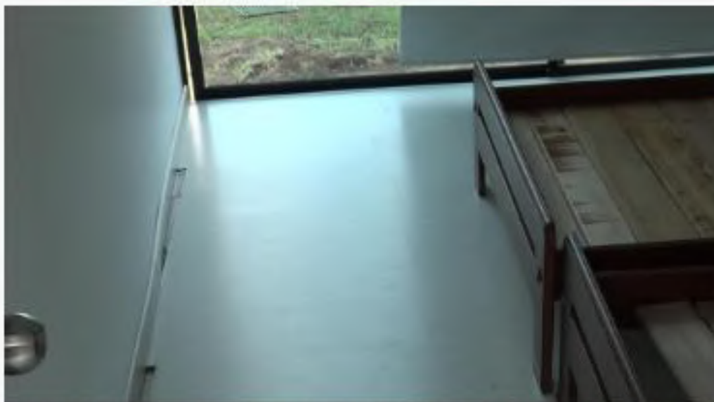
Foto No 11: Detalle de separación entre muros y pisos que evidencia movimiento de muros y pérdida de verticalidad. Adicionalmente evidencia de que sobre el enchape en baldosa original de los pisos se instaló laminado.
