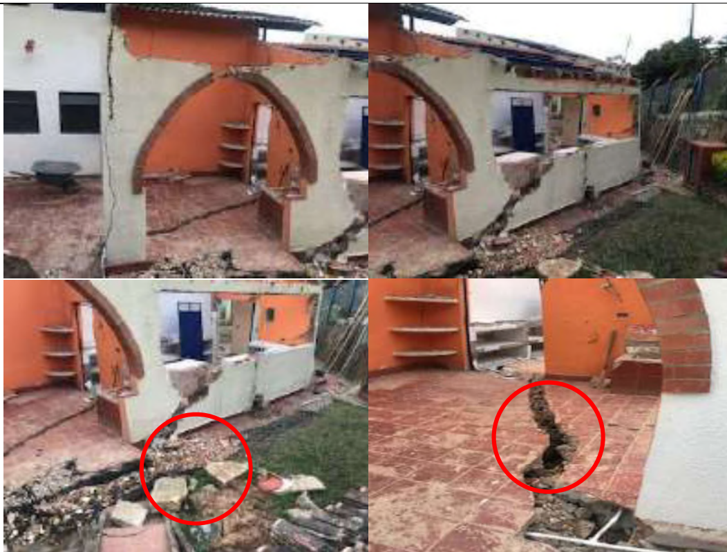
Agrietamientos en la vivienda colapsada, lote 4, filtro perimetral a la estructura.
