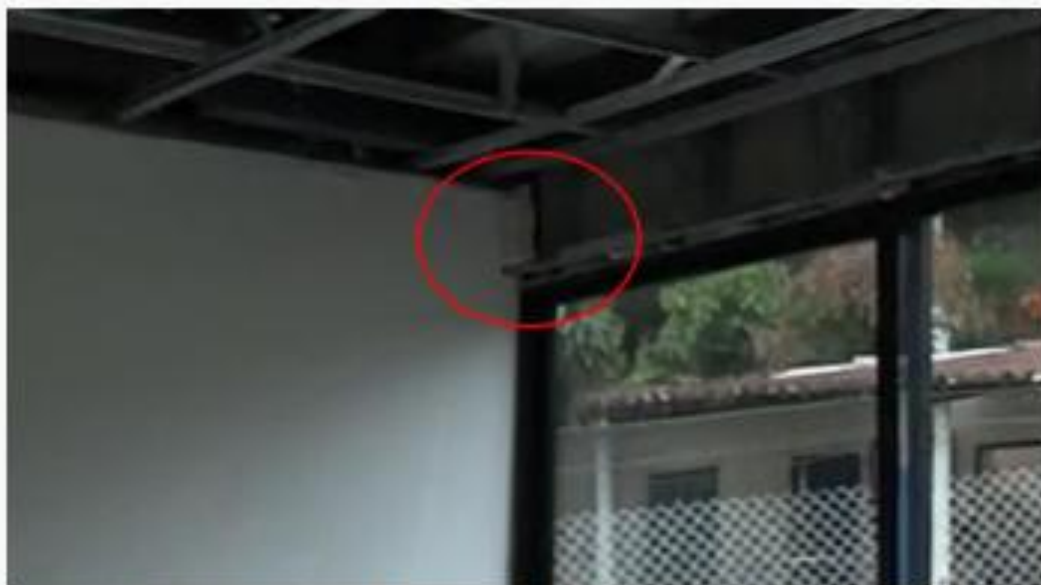
Foto No 9. Detalle de separación entre muros por pérdida de verticalidad que causa el desprendimiento de laminas de drywall.
