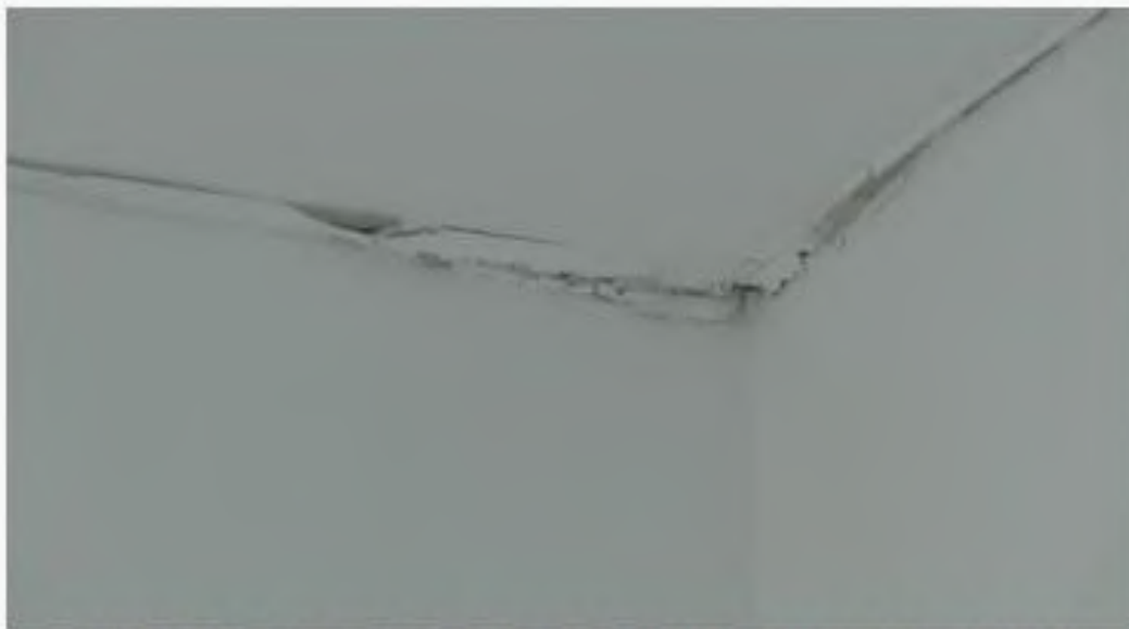
Foto No 10 : Detalle de desprendimiento entre muros en Superboard y cielos rasos en Drywall señales de desplazamiento en muros y pérdida de verticalidad.
