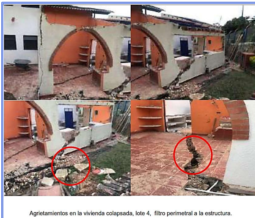
Vivienda colapsada en el lote 4, Rincón del Bosque. (Fuente: Acta de visita Alcaldía de Silvania)
