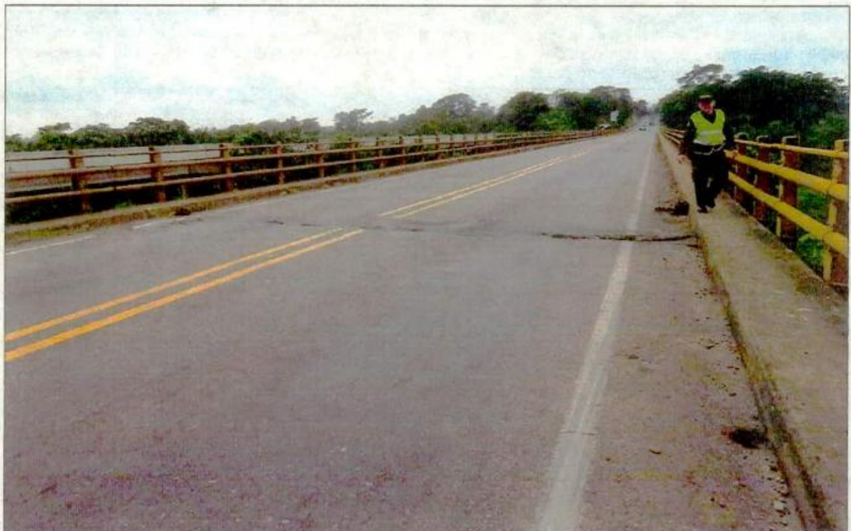
FOTOGRAFÍA No.4: Fotografía tomada antes del accidente en sentido La Lizama- San Alberto, sobre el puente que cruza el Rio Sogamoso. Una calzada con dos carriles, vía en mal estado de conservación, con deformación hundimiento, fisuras transversales y grietas en las juntas. Tramo vial recto, con señalización horizontal líneas de borde y línea central continua amarilla. Sentido vehicular de la motocicleta de placas WIF 31E
