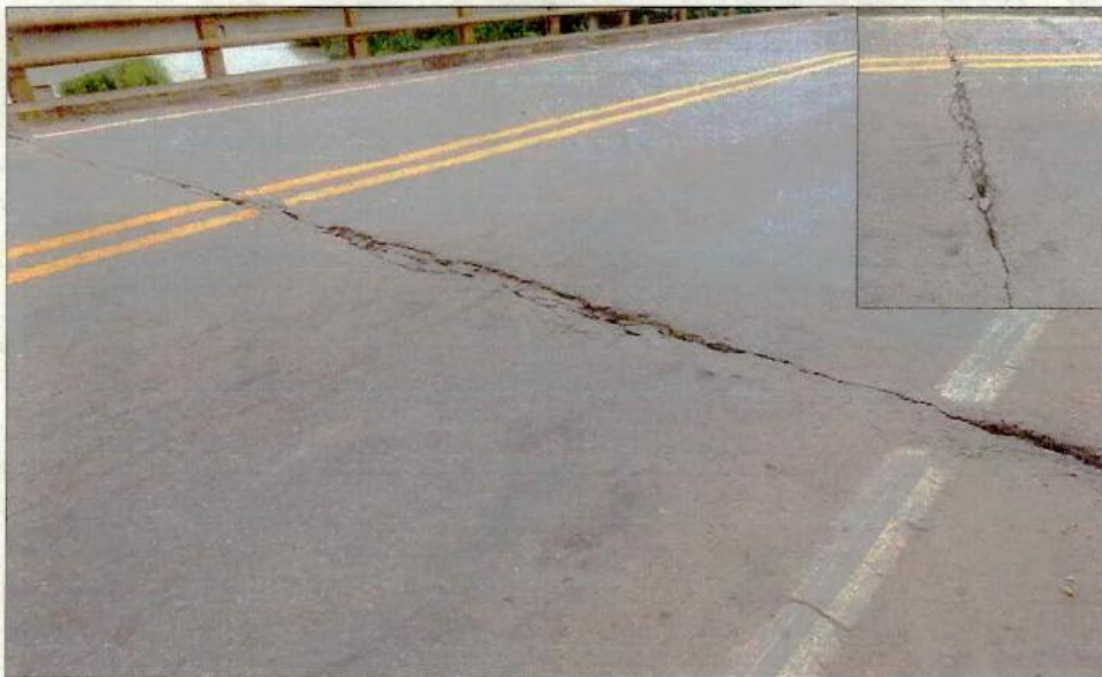
FOTOGRAFÍA No.3: Fotografía tomada a 70 metros antes del accidente en sentido La Lizama- San Alberto, sobre el puente que cruza el Rio Sogamoso. Una calzada con dos carriles, vía en regular estado de conservación, con hundimiento, fisuras transversales y grietas en las juntas. Tramo vial recto, con señalización horizontal líneas de borde y línea central continua amarilla, con andenes en los costados con un ancho de 0,60 metros y bermas de 0,70 metros, sitio despoblado. Sentido vehicular de la motocicleta de placas WIF 31E
