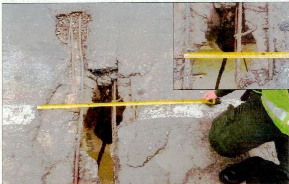
FOTOGRAFÍA No.7: Fotografía tomada en el área de impacto en sentido La Lizama- San Alberto, sobre el puente que cruza el Rio Sogamoso. Vía en mal estado de conservación, con hundimiento, fisuras transversales y grietas en las juntas, con una medida longitudinal de 0,39 metros, perdiendo la totalidad de las capas. Sentido vehicular de la motocicleta de placas WIF 31E
