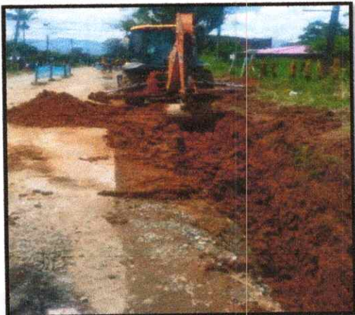
FOTOGRAFIA 3: SE SACA FALLO EN RELLENO REALIZADO EN TRAMO DESDE LA CAMARA 19 A LA CAMARA 18 DEL ALCANTARILLADO PLUVIAL
