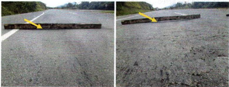
FOTOGRAFIAS N° 05 y 06 Panorámicas: Vía Buenaventura - Buga kilómetro 90 + 500 Mts al 90 + 600 Mts, en esta imagen se aprecia las fallas en la geometría de la vía.
