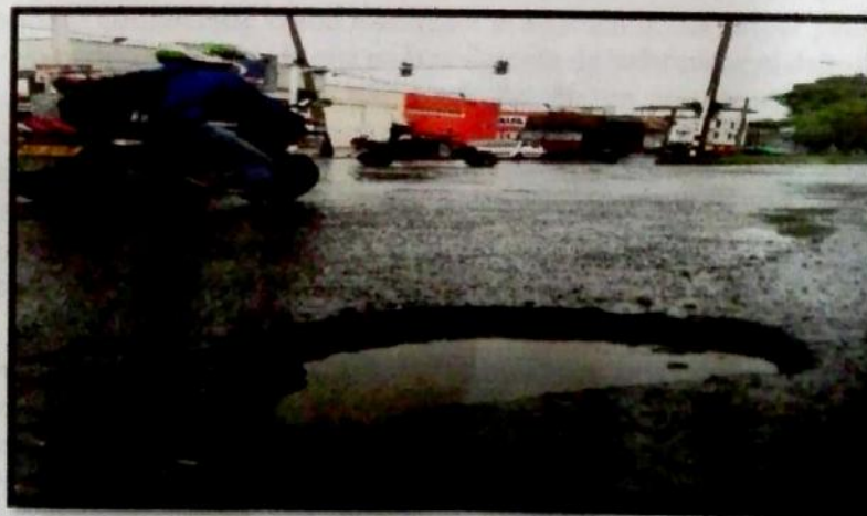
(Fotografía del día 08 de mayo de 2018 del accidente donde se observa el hueco)
