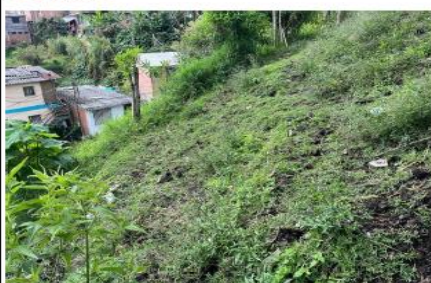
Foto 11. Son evidentes las señales de erosión en la parte superior del talud, dado por la falta de un sistema de manejo de aguas de escorrentía, superficiales y sub superficiales adecuados.
