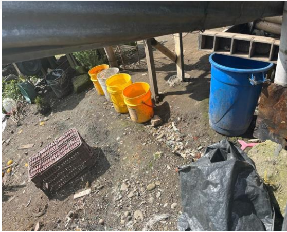
Foto 9. Los patios de las viviendas en la corona del talud no poseen revestimientos y los techos no presentan sus respectivos canales y bajantes, por lo que la incidencia de las aguas lluvias sobre el suelo es evidente.
