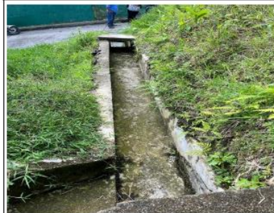
Foto 3. Entrega de las aguas del canal sobre la vía, calle 5C, que recibe a través del alcantarillado.
