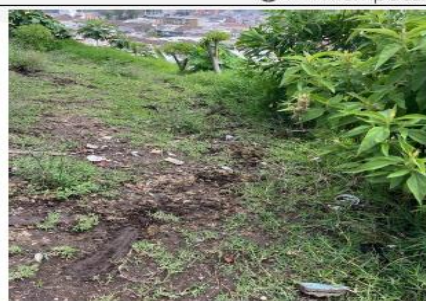
Foto 10. Las incidencias del caminar de los animales domésticos sobre el suelo desnudo en la corona del talud, es latente, que convierten la corona del talud en una zona de recarga.
