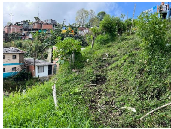
Foto 12. Se advierte la necesidad de una zanja de coronación en la pantalla existente, para que se capten y manejen las aguas en la corona del talud, indicadores de su falta que son evidentes en el terreno.
