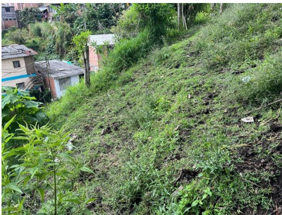
Foto 11. Son evidentes las señales de erosión en la parte superior del talud, dado por la falta de un sistema de manejo de aguas de escorrentía, superficiales y sub superficiales adecuados.
