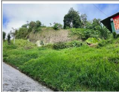
Foto 1. Talud objeto del siniestro en el mes de enero de 2017.
