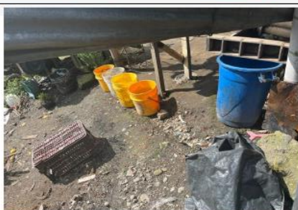
Foto 9. Los patios de las viviendas en la corona del talud no poseen revestimientos y los techos no presentan sus respectivos canales y bajantes, por lo que la incidencia de las aguas lluvias sobre el suelo es evidente.
