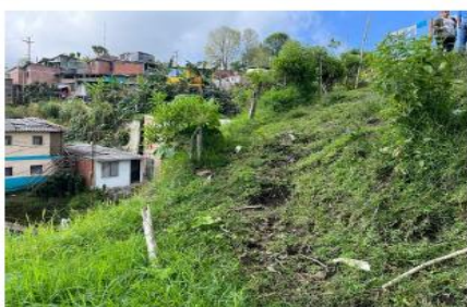
Foto 12. Se advierte la necesidad de una zanja de coronación en la pantalla existente, para que se capten y manejen las aguas en la corona del talud, indicadores de su falta que son evidentes en el terreno.
