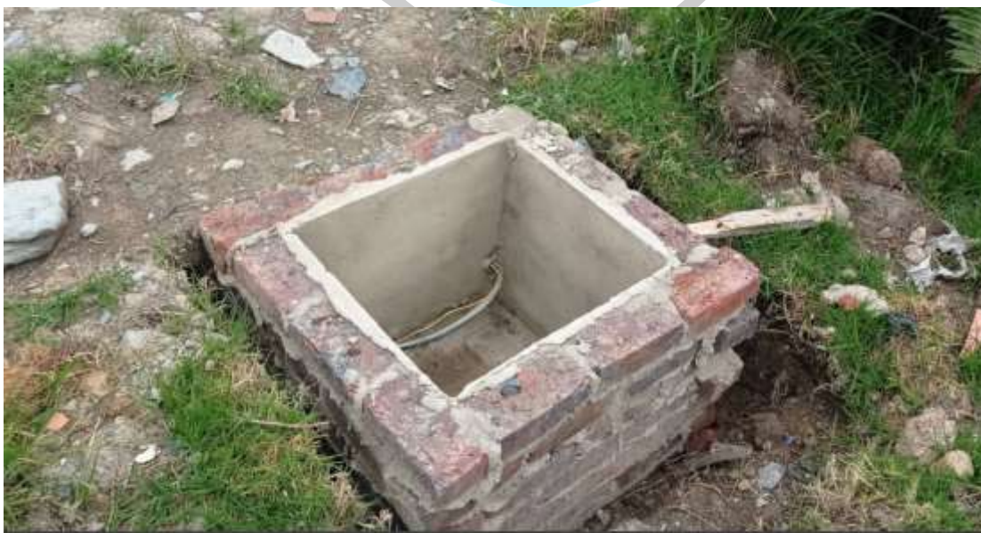
Esta ubicada entre el poste y el muro donde se instalo el medidor.
