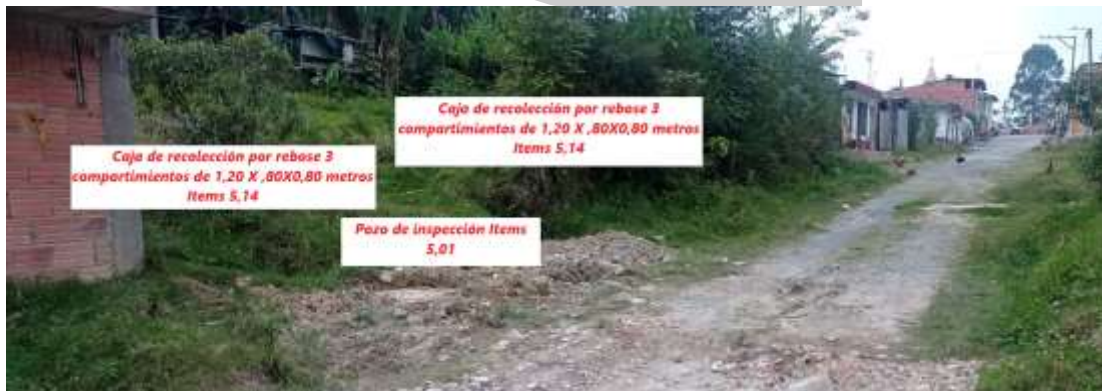
Ubicación de pozo que no fue visible en la inspecciona técnica
