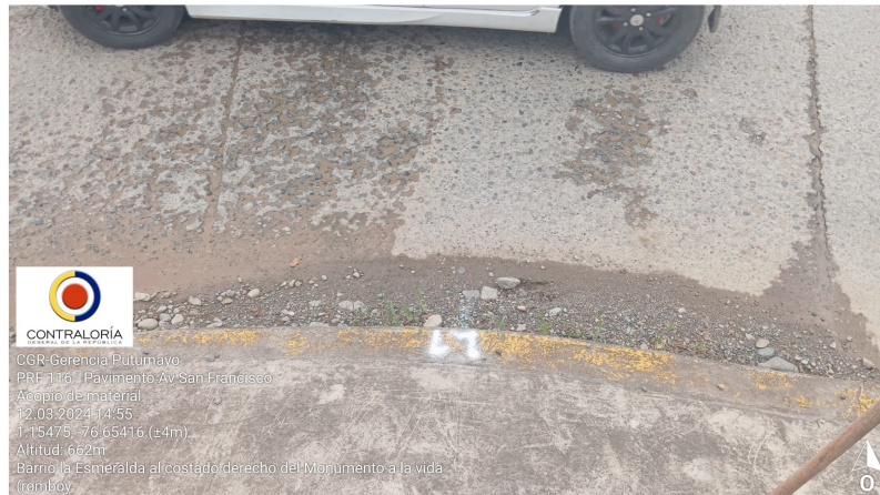
Foto No. 10 – losas No. 4-5 Y 6- Presencia de Material Grueso Granular en superficie del Pavimento – Contorno Glorieta
