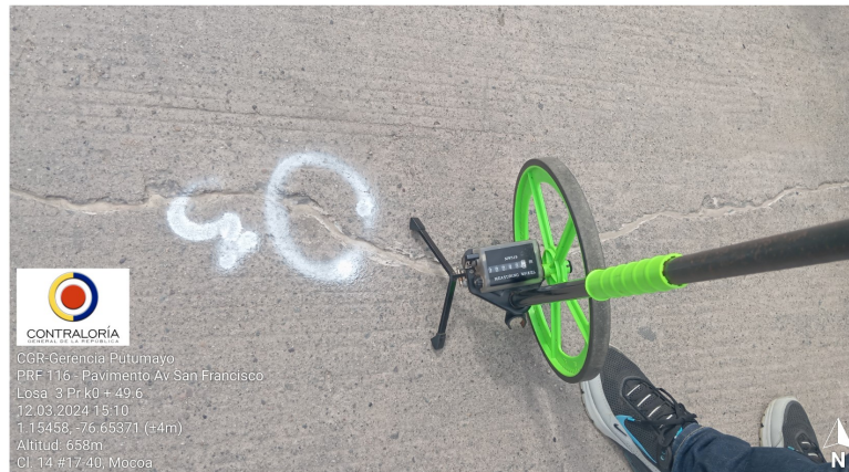
Foto No. 3 – Fisura losa No. 3- K0+049.6 – sellada con SikaFlex 401 Pavement SL- Sellador Elástico
