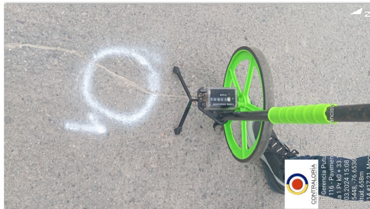
Foto No. 1 – Fisura losa No. 1- K0+033,1 – sellada con SikaFlex 401 Pavement SL- Sellador Elástico
