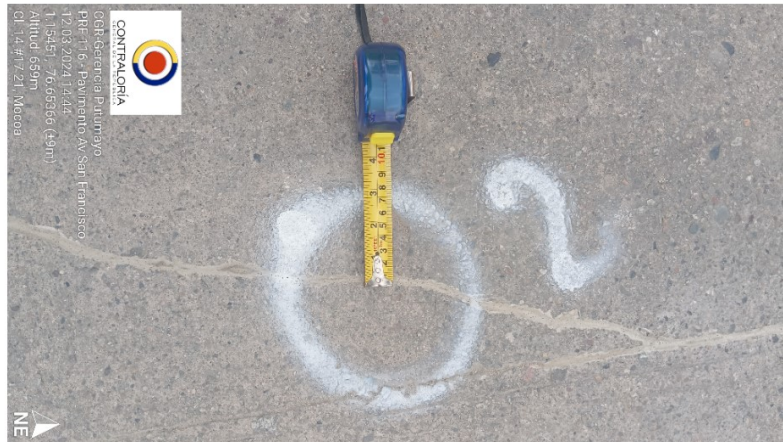
Foto No. 2 – Fisura losa No. 2- K0+039,2– sellada con SikaFlex 401 Pavement SL- Sellador Elástico
