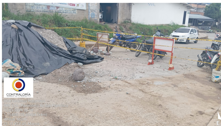
Foto No. 12 – losas No. 4-5 Y 6- Presencia de Material de obra que produciendo obstrucciones por la sedimentación de materiales acarreados – Contorno Glorieta
