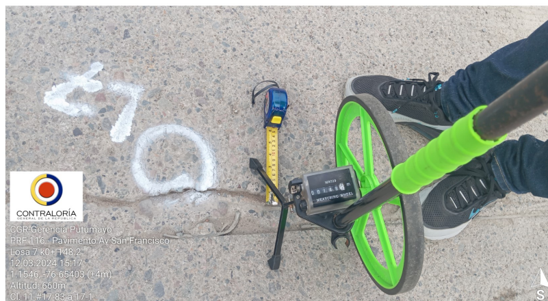
Foto No. 4 – Fisura losa No. 7- K0+148.2 – sin reparación
