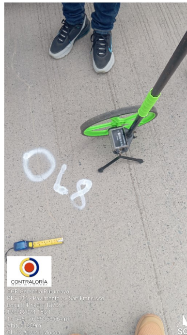
Foto No. 6 – Fisura losa No. 8- K0+187,2 – sellada con SikaFlex 401 Pavement SL- Sellador Elástico
