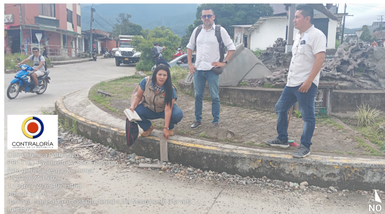
Foto No. 11 – losas No. 4-5 Y 6- Presencia de Material Grueso Granular en superficie del Pavimento – Contorno Glorieta
