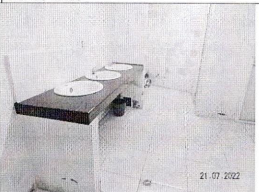
Centro cultural La Paz. Nivel C, batería sanitaria, mesón en concreto acabado porcelanato, aparatos sanitarios, grifería
