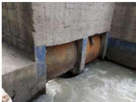
COMPUERTAS DE CONTROL Y CIERRE.
