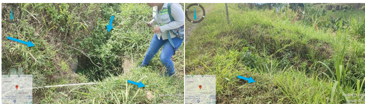
Figura 1.30. Condiciones de la alcantarilla 2
