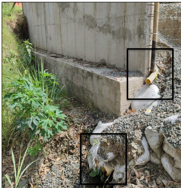
Figura 1.12. Descargas evidenciadas en la zona inestable
