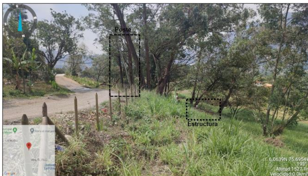
Figura 1.22. Evidencia de movimientos (Postes, estructuras y arboles)
