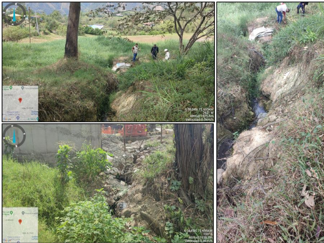
Figura 1.23. Erosión en zonas de descarga de obras hidráulicas
