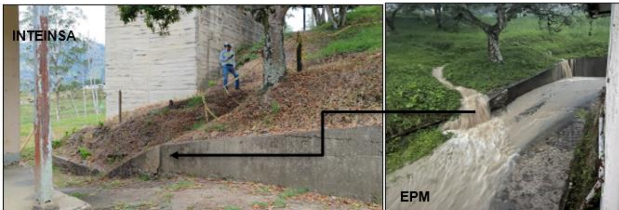
Figura 1.25. Afectación en estructuras producto de los flujos de agua EPM ESP. (2024). Fotos Gualí. Medellín
