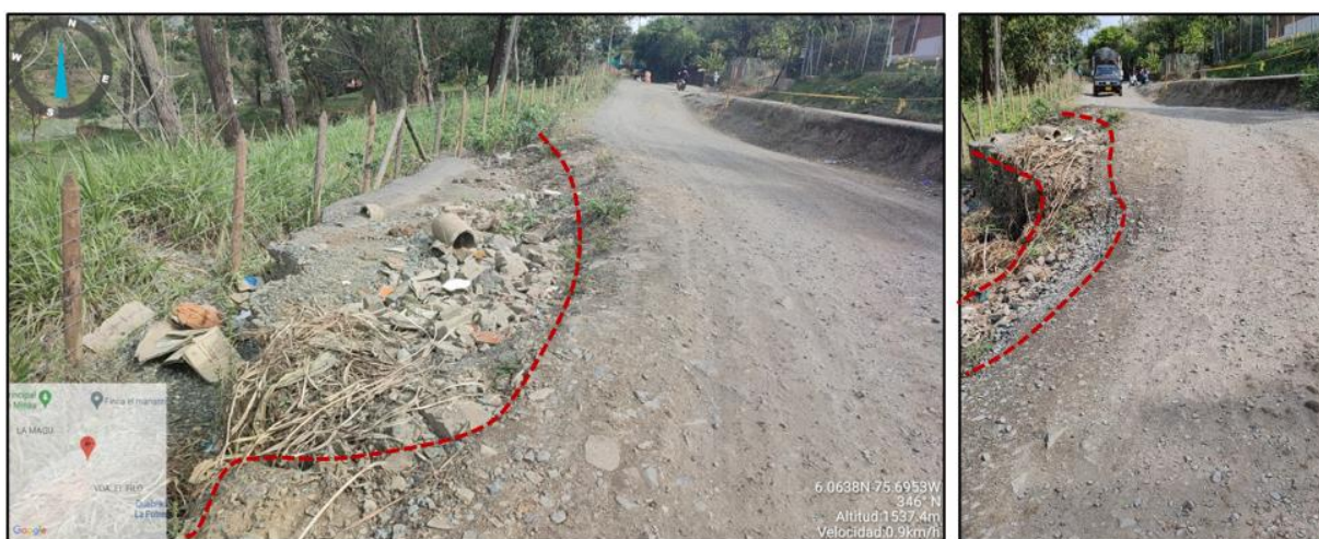
Figura 1.8. Deterioro de la vía
