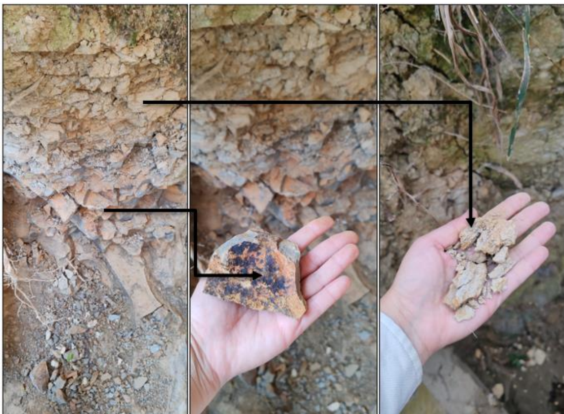
Figura 1.16. Material encontrado en la ladera parte alta Tramo 3 (100 m)
