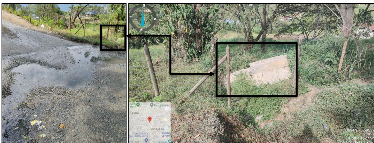
Figura 1.6. Zona de empozamiento y descole fallado
