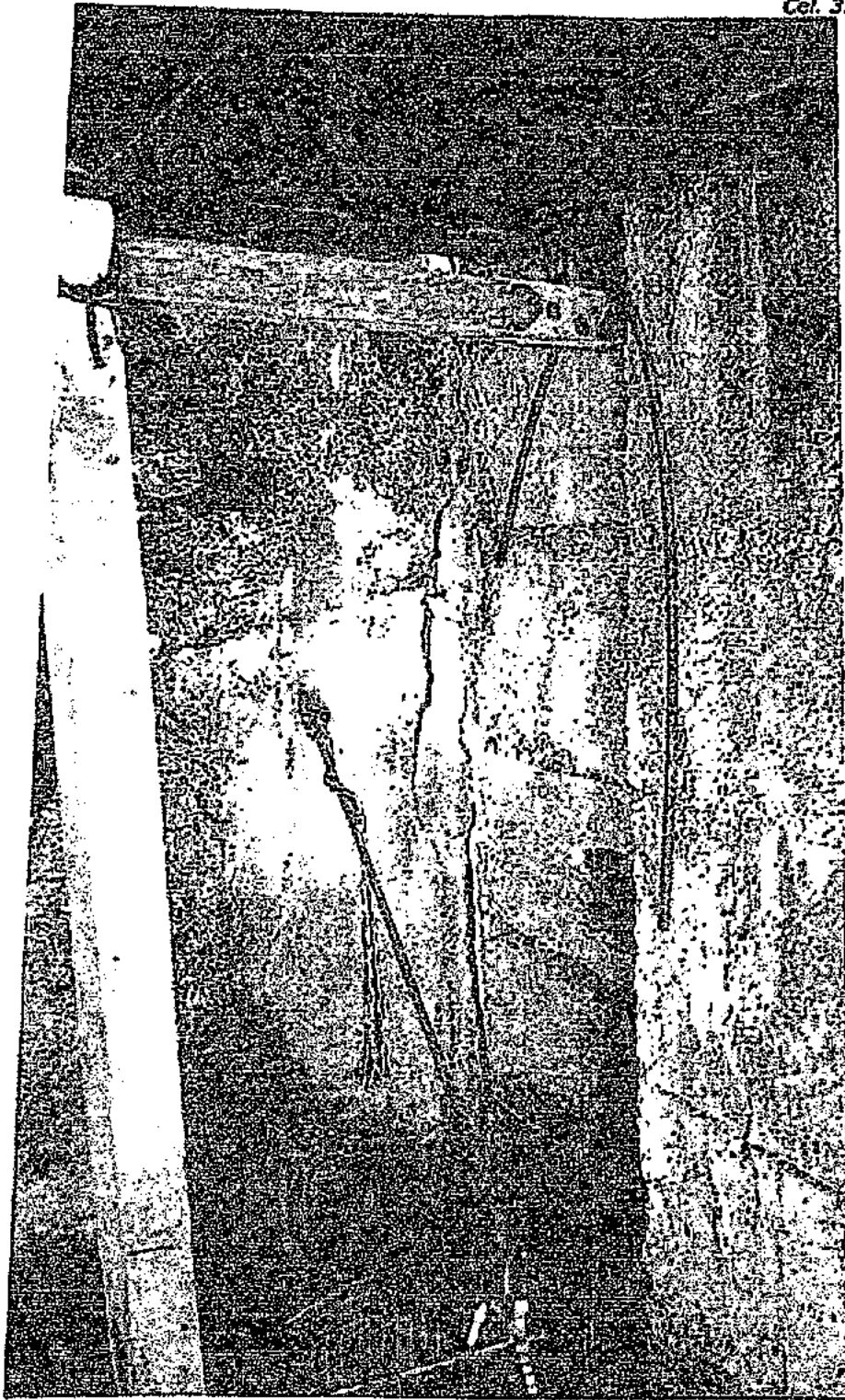
Daño en muro de cerramiento, este corresponde a la grieta del daño #6 presentado al principio.
