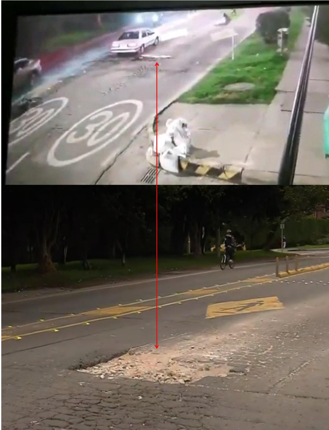
Imagen No.14: Compuesta de una imagen extraída del video de la cámara de seguridad (superior) versus imagen extraída de los medios de comunicación (inferior), donde se hace referencia del hueco presente en la vía el día que ocurrieron los hechos.
