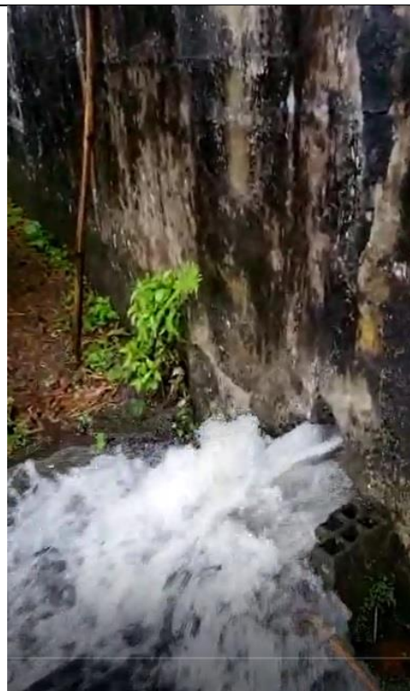
Foto 2. Ruptura de la canal de conducción de aguas en la corona del deslizamiento
