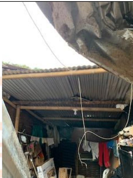
Foto 7. Afectación de la cubierta asentamiento informal por caída de árboles costado Este del deslizamiento.
