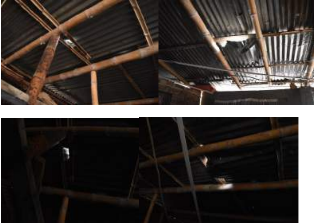
Agujeros provocados por los gases lacrimógenos y piedras lanzadas por el ESMAD desde el puente, perforaron el techo. (31/05/2021)
