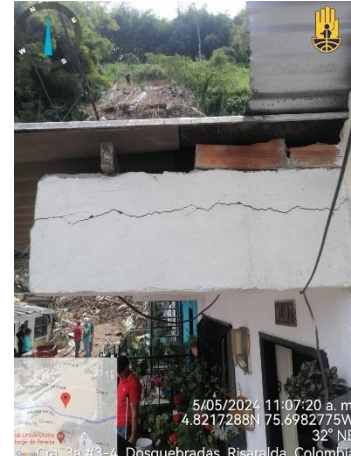
FOT 2. Grieta en fachada Manzana L Casa 7 Barrio la Esneda Dosquebradas
