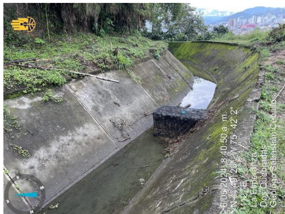
Foto 5. Salida de agua de la acequia funcionando correctamente
