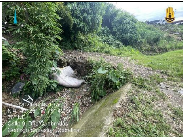
Foto 3. Escombros obstaculizando la acequia
