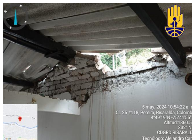
Foto 10. Daños en la cubierta vivienda manzana K casa 13
