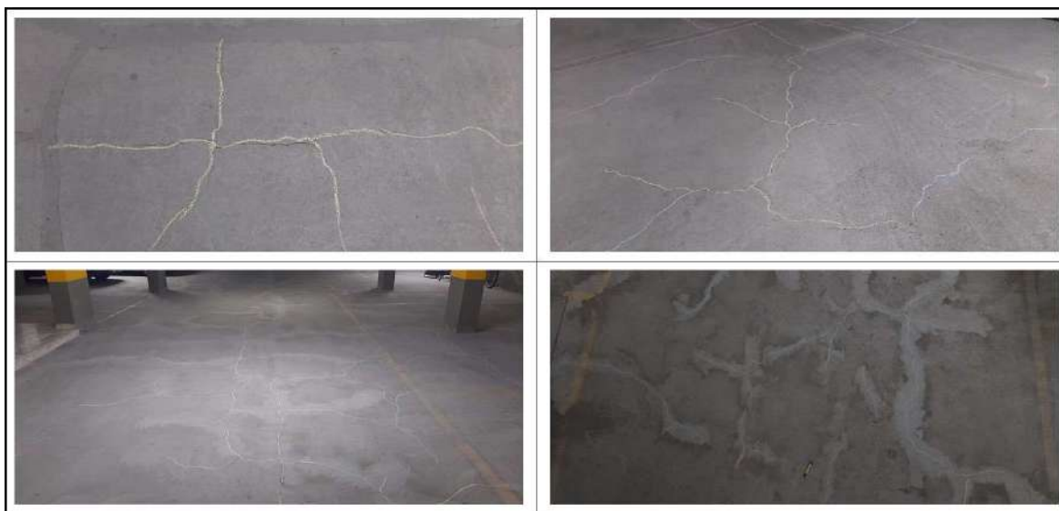
Foto 8 – Fisuras por contracción
