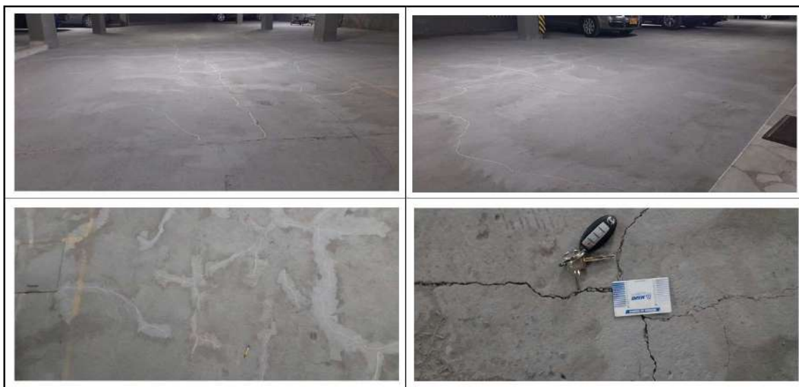
Foto 9 – Fisuras por falta de juntas
