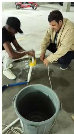
Imagen 55. Bombeo efectuado con bomba de 1.5 H.P. extrayendo agua de un sifón que permanece anegado. El concreto luego de extraída el agua, se seca, de acuerdo a información del Contratista.
