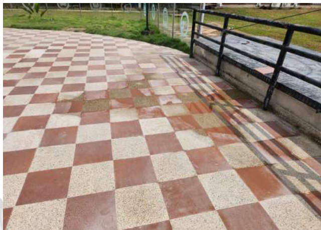
Foto 15: Empozamiento de agua debido a falta de nivelación en piso de piscina
