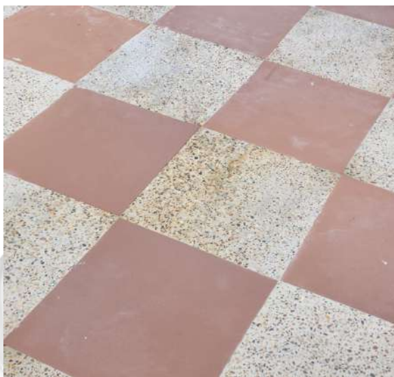
Foto 2: Mala aplicación de granito
