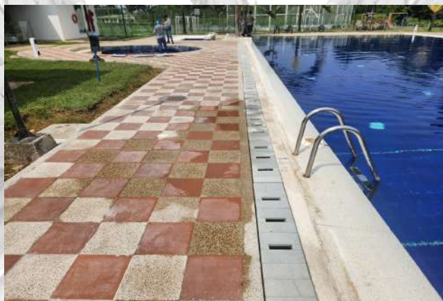
Foto 16: Empozamiento de agua debido a falta de nivelación en piso de piscina
