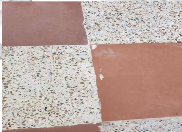
Foto 1: Tabletas manchadas de mortero
