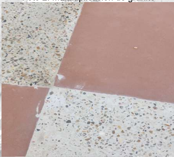
Foto 3: Tabletas manchadas de mortero
