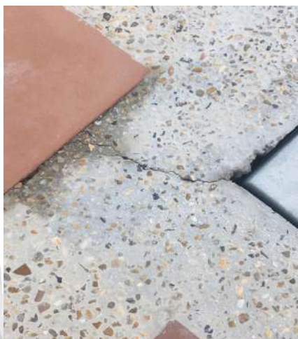
Foto 10: fisura en granito
