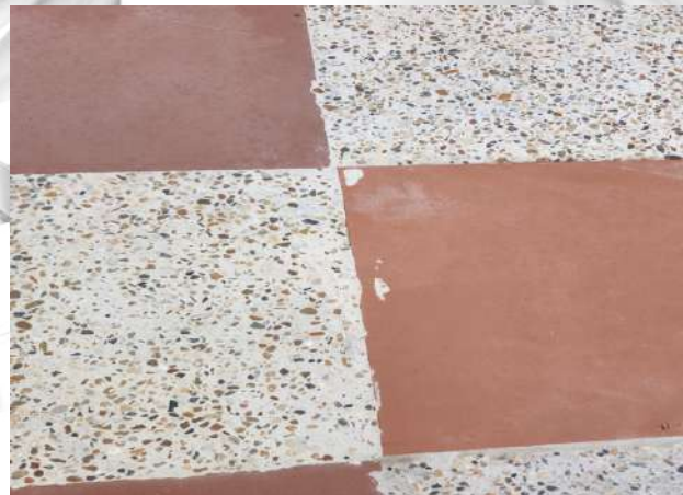
Foto 1: Tabletas manchadas de mortero
