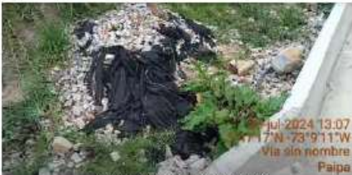
Imagen 12. Geotextil dañado del filtro N°3
