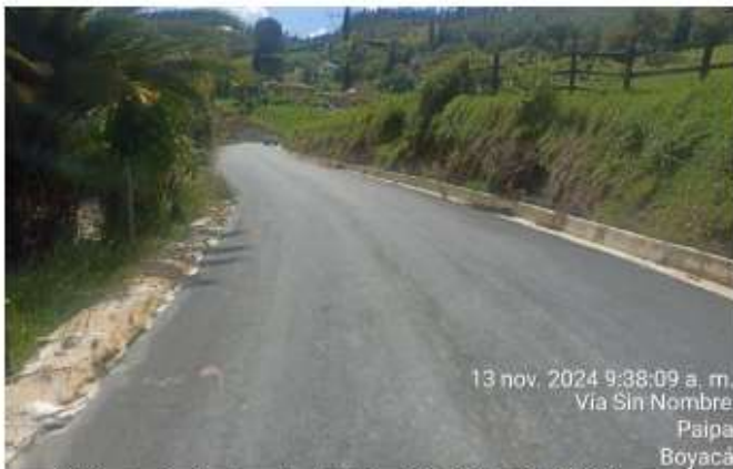
Imagen 31. Cuneta sin ejecutar entre la abscisa K0+663 a la K0+683.19, costado derecho
