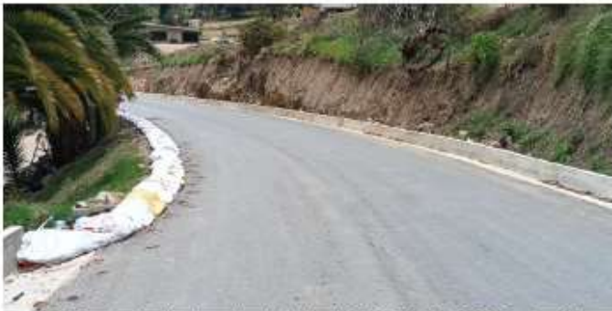
Imagen 30. Cuneta sin ejecutar entre la abscisa K0+663 a la K0+683.19, costado derecho
