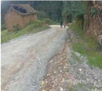
Imagen 6. Deterioro de material de sub base granular, entre las abscisas K0+230 a K0+210, costado izquierdo
