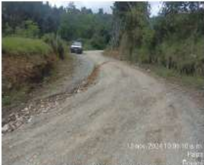
Imagen 8. Fotografía k0+235 al K0+270, estado actual sub base granular conforme a la visita del 13 de noviembre de 2024.
