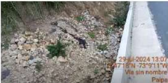
Imagen 13. Material filtrante disperso del filtro N°3.
