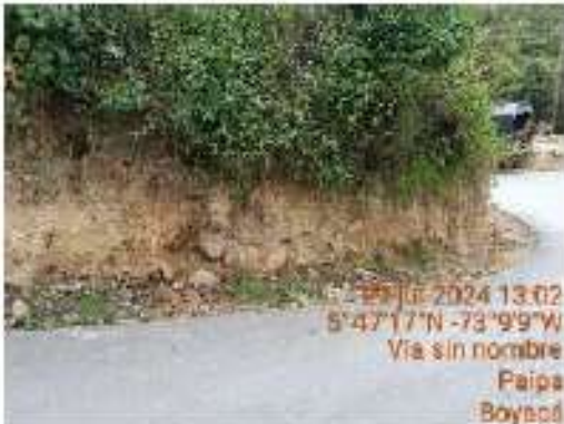
Imagen 9. Arrastre del material de la subrasante en la curva 12 entre las abscisas K0+540 a K0+490, costado derecho (zona donde el contratista no ejecuto la cuneta)
