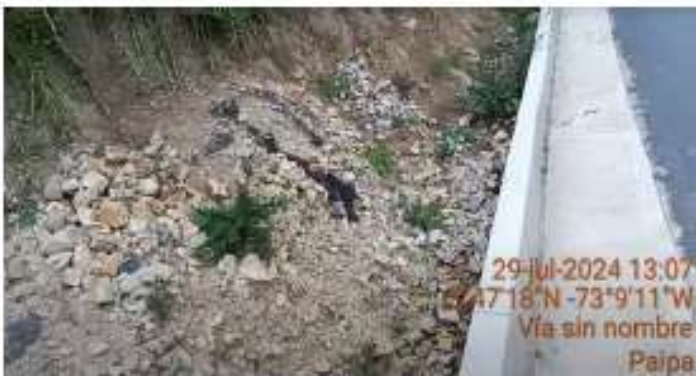
Imagen 13. Material filtrante disperso del filtro N°3.
