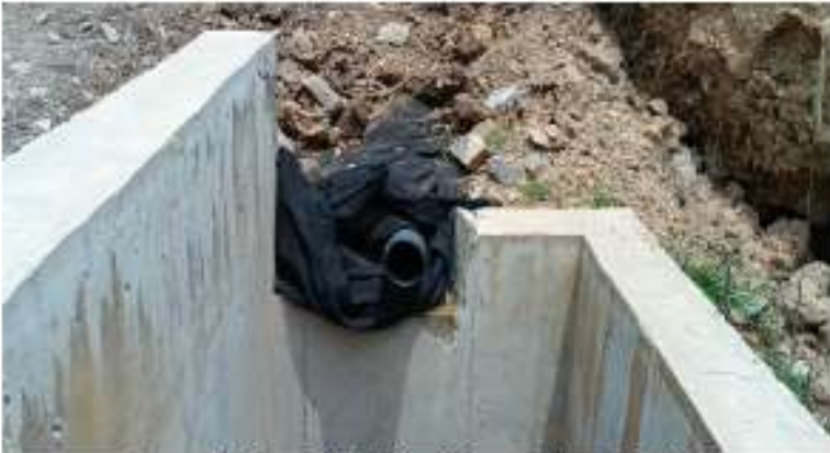
Imagen 10. Conexión del filtro N°2 con la alcantarilla N°2.
