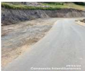
Imagen 19. Arrastre del material de la subrasante entre las abscisas K0+460 a K0+430, costado izquierdo.
