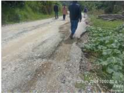
Imagen 13. Estado actual de la sub base entre las abscisas K0+290 a K0+305, costado izquierdo
