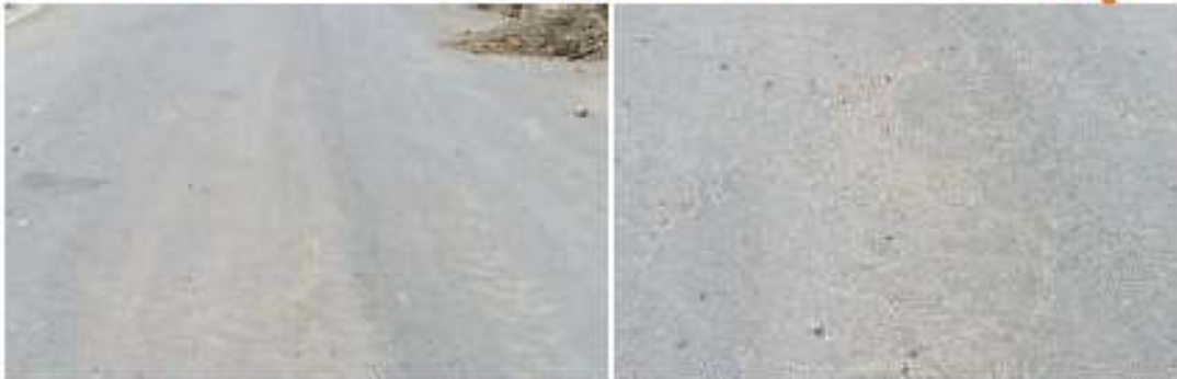
Imagen 17. Marcas producidas en la carpeta de asfalto por la rotación de las llantas de la retroexcavadora.
