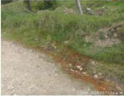
Imagen 2. Estado actual Agua sub superficial sobre filtro No 1 Absc K0+075
