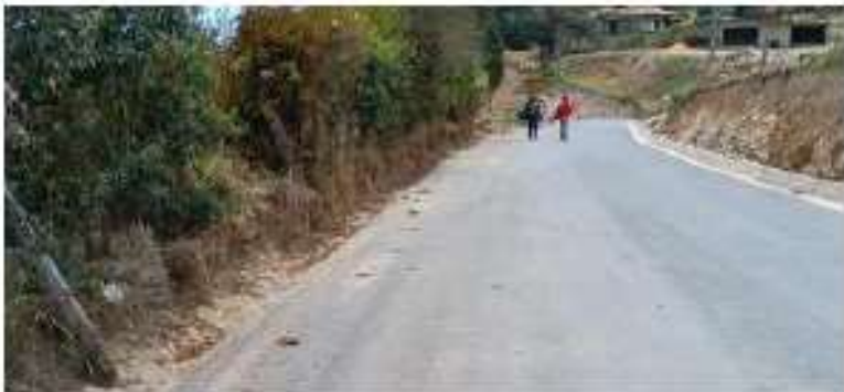
Imagen 14. Cuneta sin ejecutar entre la abscisa K0+670 a K0+635 costado izquierdo
