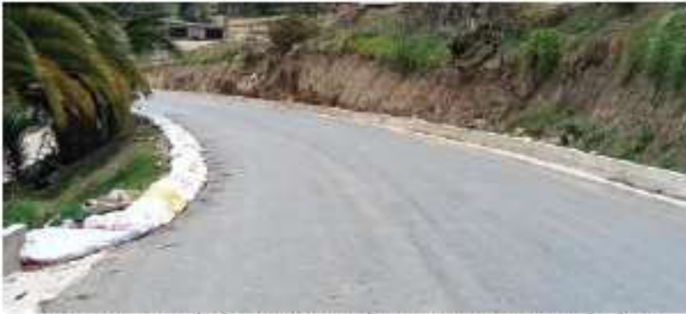
Imagen 15. Cuneta sin ejecutar entre la abscisa K0+730 a K0+695 costado izquierdo
