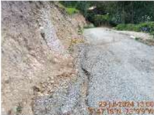
Imagen 7. Arrastre del material de la subrasante entre las abscisas K0+450 a K0+430, costado izquierdo.
