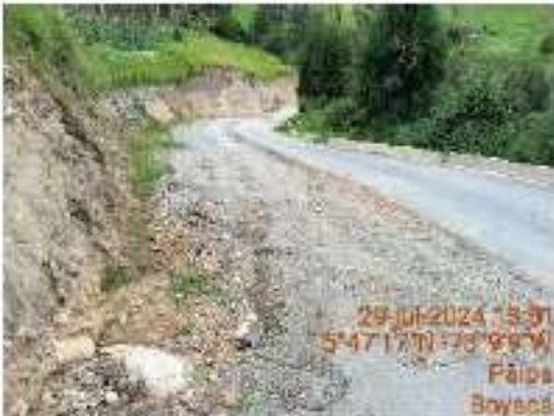
Imagen 8. Arrastre del material de la subrasante entre las abscisas K0+490 a K0+480, costado derecho.
