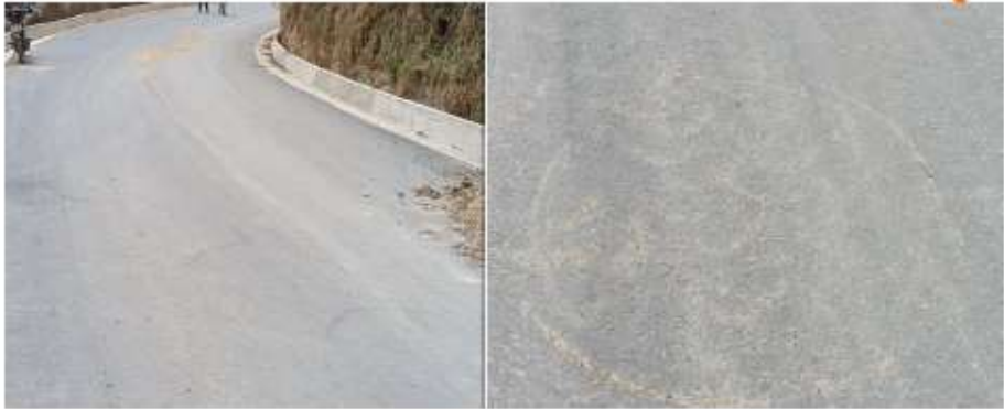
Imagen 32. Marcas producidas en la carpeta de asfalto por la rotación de las llantas de la retroexcavadora.
