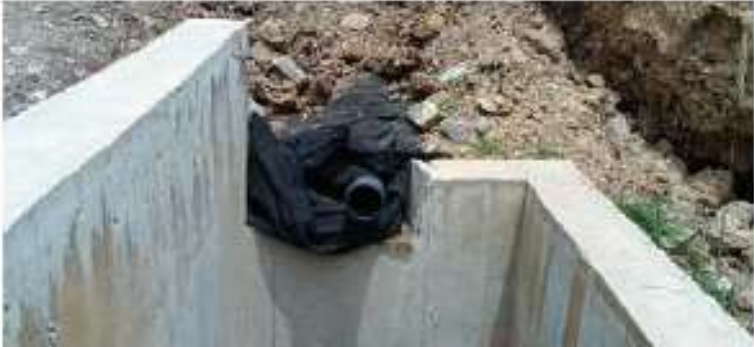
Imagen 10. Conexión del filtro N°2 con la alcantarilla N°2.
