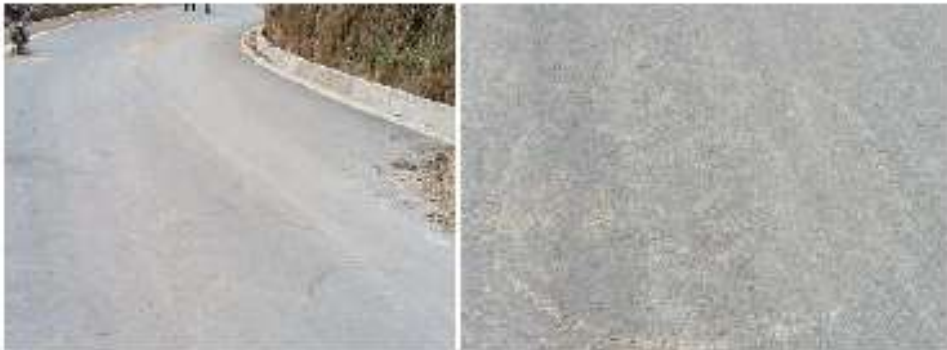
Imagen 16. Marcas producidas en la carpeta de asfalto por la rotación de las llantas de la retroexcavadora.
