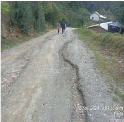
Imagen 16. Estado actual de la sub base en la curva 8 entre las abscisas K0+320 a K0+370, costado derecho
