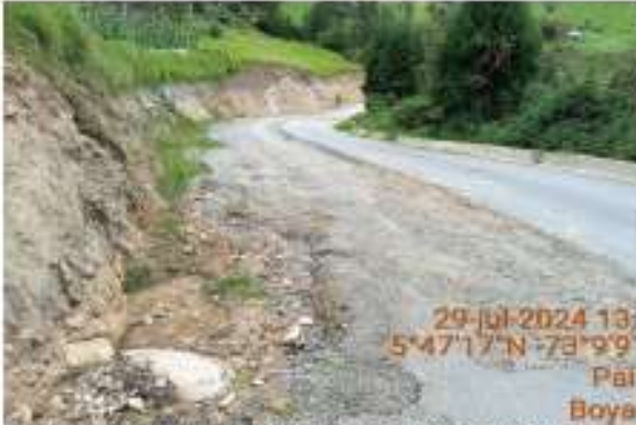
Imagen 8. Arrastre del material de la subrasante entre las abscisas K0+490 a K0+480, costado derecho.
