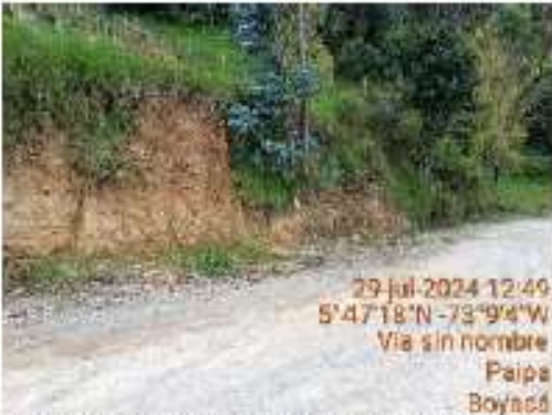
Imagen 3. Crecimiento de material vegetal por la exposición de la subrasante, entre las abscisas K0+140 a la K0+160 costado derecho.
