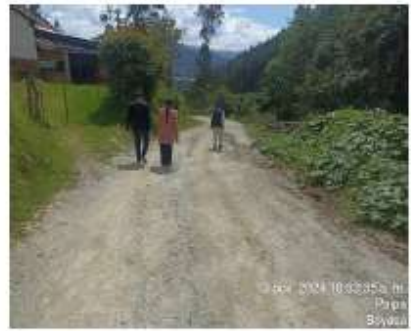
Imagen 12. Estado actual de la sub base entre las abscisas K0+290 a K0+305, costado izquierdo
