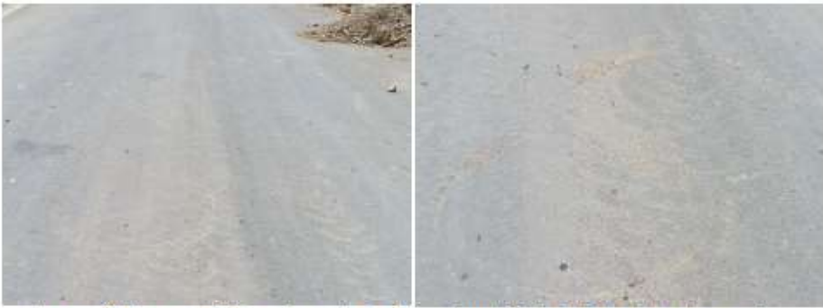
Imagen 33. Marcas producidas en la carpeta de asfalto por la rotación de las llantas de la retroexcavadora.
