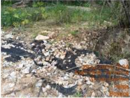
Imagen 1. Geotextil deteriorado del filtro N°1 cerca de la conexión con la alcantarilla N°1.
