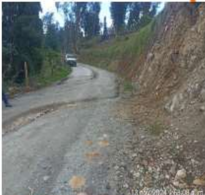
Imagen 22. Arrastre del material de la subrasante entre las abscisas K0+490 a K0+480, costado derecho
