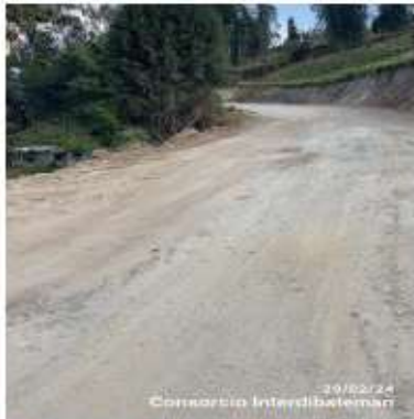
Imagen 21. Arrastre del material de la subrasante entre las abscisas K0+490 a K0+480, costado derecho
