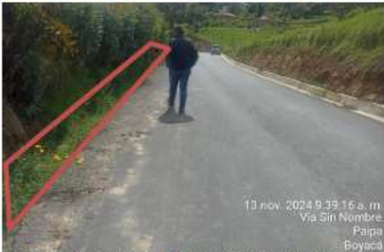
Imagen 29. Cuneta sin ejecutar entre la abscisa K0+592 a la K0+663 costado derecho
