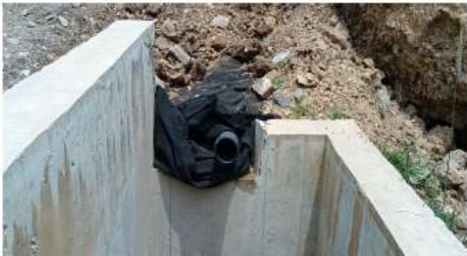
Imagen 23. Conexión del filtro N°2 con la alcantarilla N°2.
