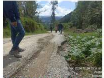
Imagen 14. Estado actual de la sub base entre las abscisas K0+290 a K0+305, costado izquierdo
