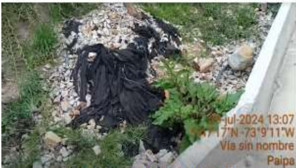
Imagen 25. Geotextil dañado del filtro N°3
