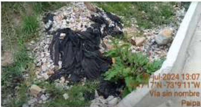
Imagen 12. Geotextil dañado del filtro N°3
