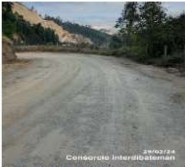
Imagen 3. Abscisa K0+185, estado subrasante previo a la suspensión de las actividades de obra
