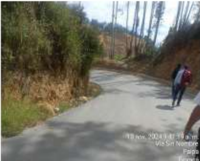
Imagen 28. Arrastre del material de la subrasante entre las abscisas K0+490 a K0+480, costado derecho
