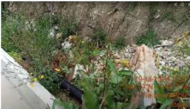
Imagen 11. Tubería expuesta del filtro N°3.
