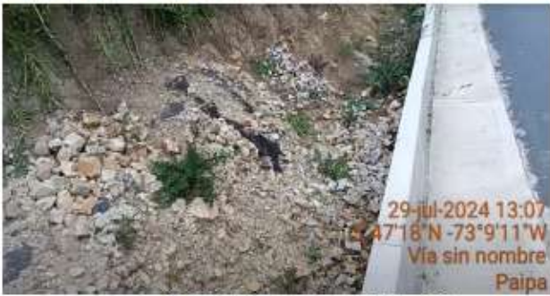
Imagen 26. Material filtrante disperso del filtro N°3.
