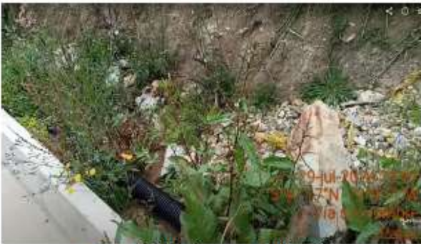
Imagen 24. Tubería expuesta del filtro N°3.
