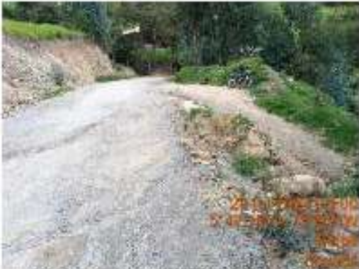
Imagen 6. Arrastre del material de la subrasante entre las abscisas K0+450 a K0+430, costado derecho.
