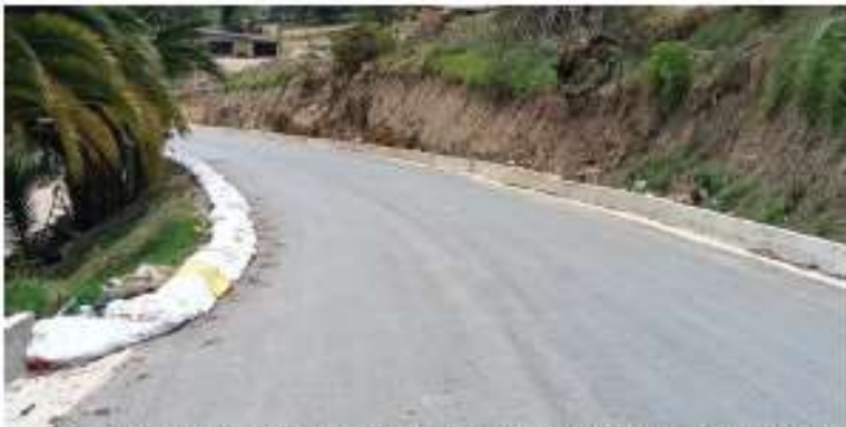
Imagen 15. Cuneta sin ejecutar entre la abscisa K0+730 a K0+695 costado izquierdo
