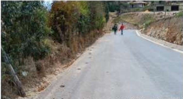
Imagen 14. Cuneta sin ejecutar entre la abscisa K0+670 a K0+635 costado izquierdo
