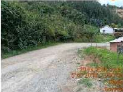
Imagen 5. Arrastre del material de la subrasante en la curva 6 entre las abscisas K0+370 a K0+320, costado derecho
