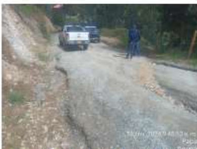
Imagen 20. Imagen 11. Arrastre del material de la subrasante entre las abscisas K0+460 a K0+430, costado izquierdo.
