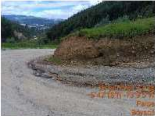
Imagen 4. Arrastre del material de la subrasante en la curva 4 entre las abscisas K0+140 a K0+110, costado derecho
