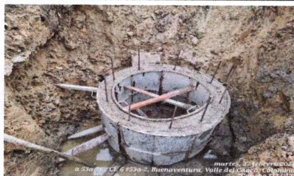
Foto 2: Función de cámara de inspección
