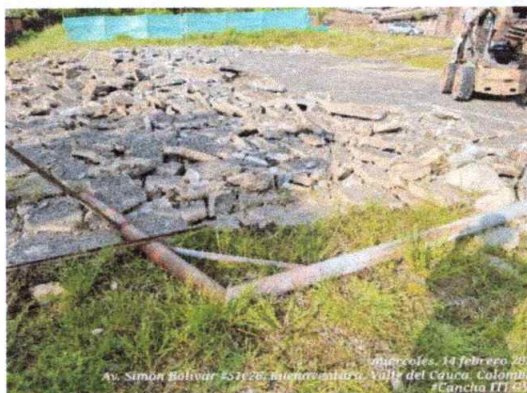
Foto 1: Desmonte existente de poste para juegos
