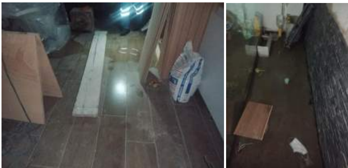
Imagen 3 imagen acumulación de agua local 419
