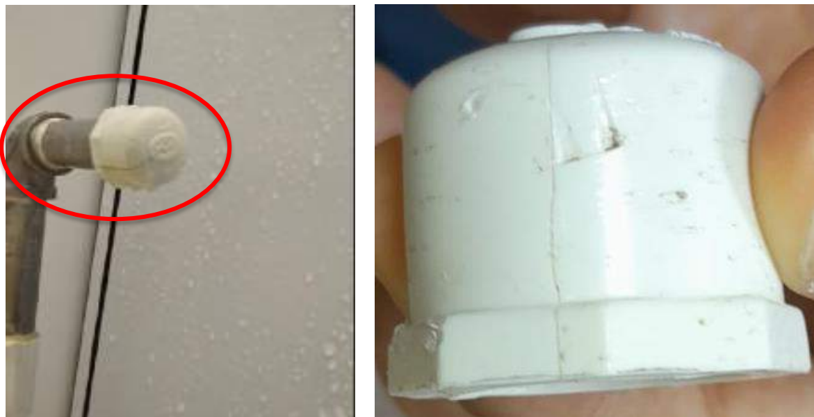
Imagen 4 Tapón PVC fisurado
