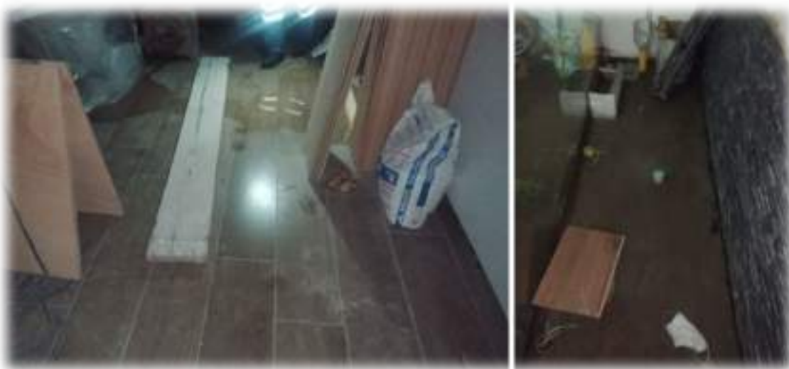
Imagen 2. Agua Acumulada en el Local 419.
