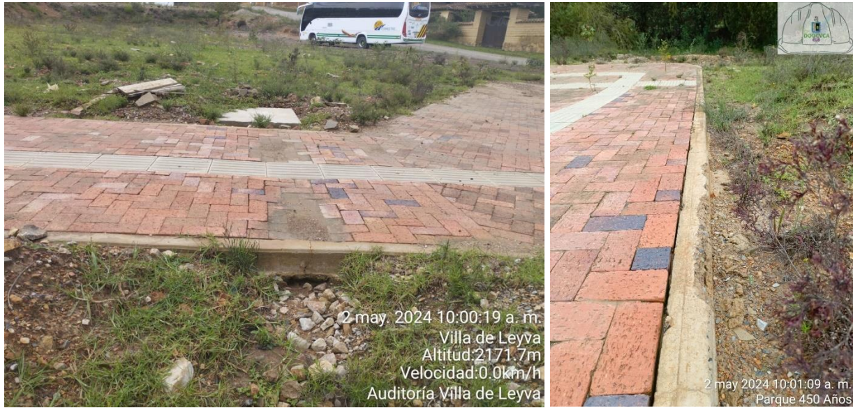
FOTOGRAFÍAS 31, 32: FISURAS Y DESGASTE DE ACABADO EN BORDILLOS. (FOTOGRAFÍAS VISITA DE FISCALIZACIÓN).
