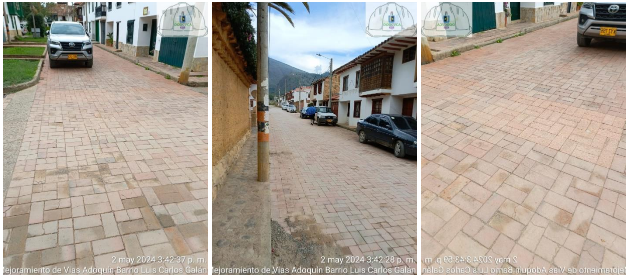
FOTOGRAFÍAS 44, 45, 46: ESTADO GENERAL VÍAS BARRIO LUIS CARLOS GALÁN (FOTOGRAFÍAS VISITA DE FISCALIZACIÓN).
