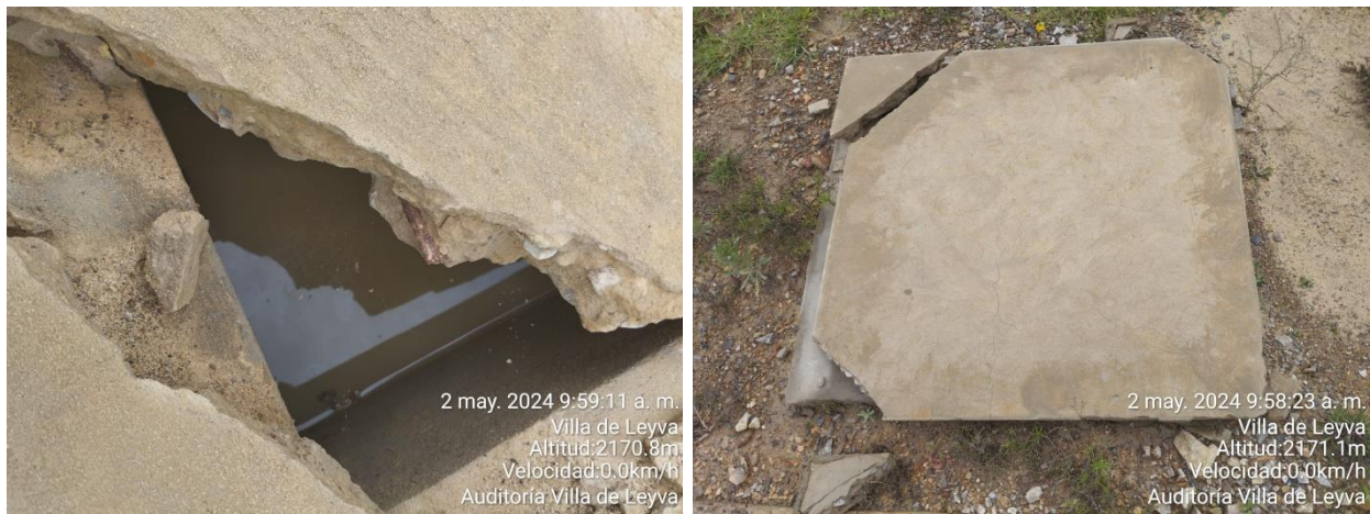
FOTOGRAFÍAS 33, 34: FISURAS Y DESGASTE DE ACABADO EN BORDILLOS. (FOTOGRAFÍAS VISITA DE FISCALIZACIÓN).
