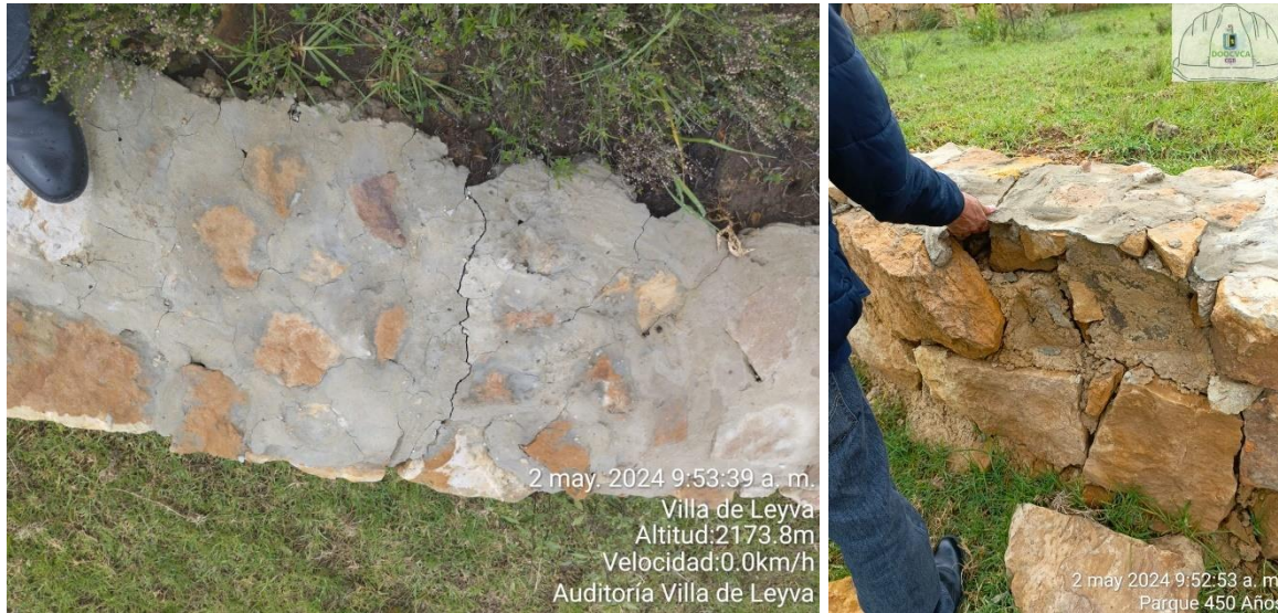
FOTOGRAFÍAS 40, 41: MURO GAVIÓN EN PIEDRA LABORADA, PRESENTA ASENTAMIENTOS, PERDIDA DE CONFINAMIENTO. (FOTOGRAFÍAS VISITA DE FISCALIZACIÓN).
