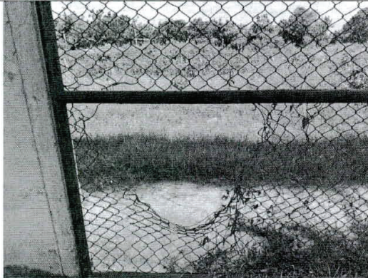
Corrosión de las tuberías metálicas y deterioro de la malla eslabonada que componen el muro de cerramiento
