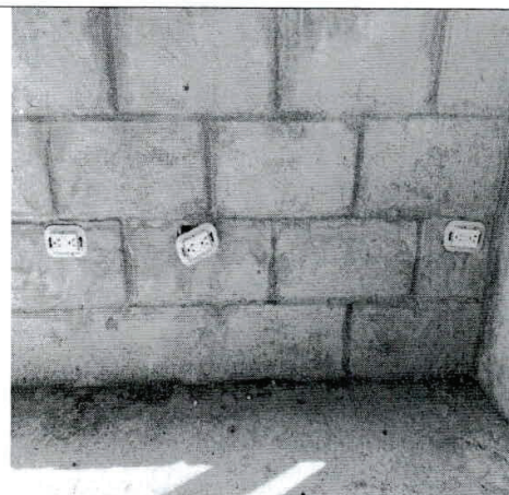
Tomacorrientes dobles 120 V sin tapas metálicas
