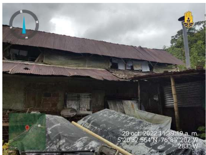
Foto 11. Registro fotográfico donde se evidencia la falta del sistema de manejo de aguas lluvias.
