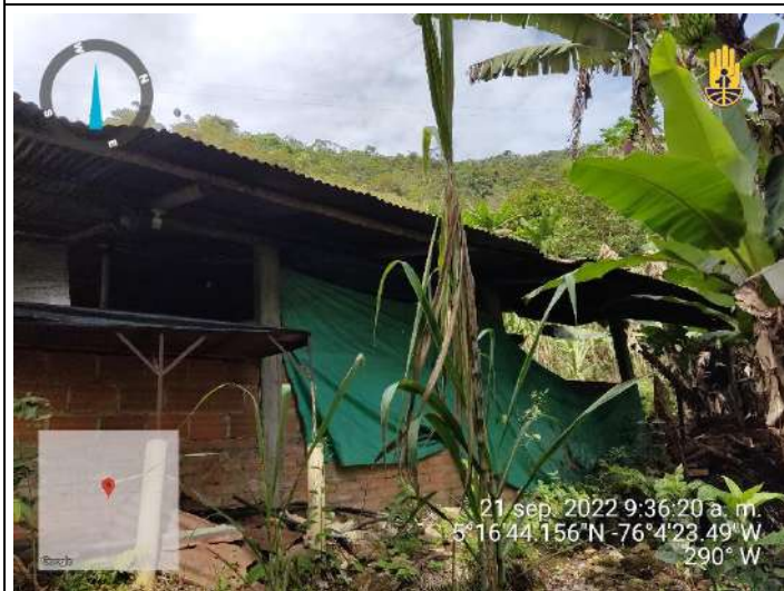
Foto 3. Ausencia de un sistema para el manejo de aguas lluvias de la estructura del trapiche.
