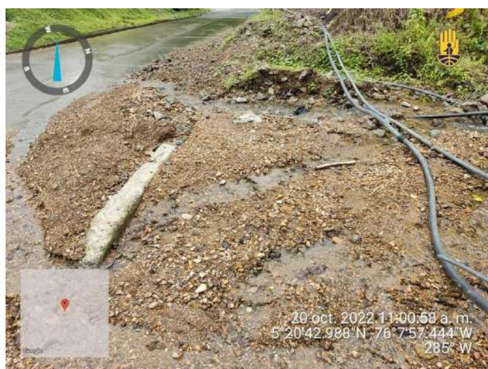
Foto 3. Registro fotográfico donde se evidencia obra hidráulica taponada por el material consolidado producto del deslizamiento.
