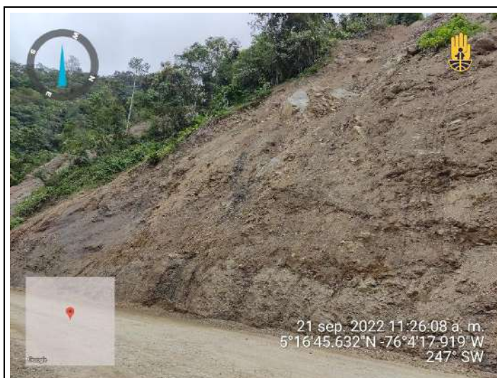
Foto 13. Vista desde la basa del deslizamiento flanco izquierdo, sobre la Vía Pueblo Rico – Santa Cecilia.
