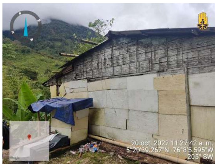
Foto 8. Registro fotográfico donde se evidencia la no presencia de sistema de manejo de aguas lluvias en la vivienda.
