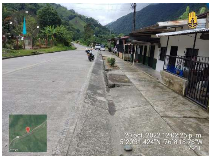
Foto 12. Registro fotográfico donde se evidencia entradas de los vehículos a las viviendas, aumentando la probabilidad de inundaciones.
