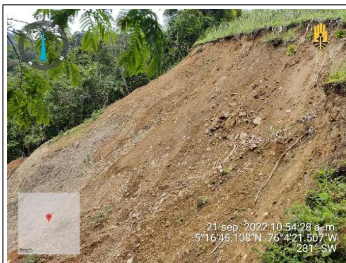
Foto 9. Estado de la corona del deslizamiento.
