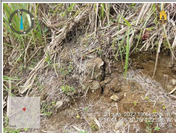
Foto 7. Registro de apertura de una de las grietas presentes en el terreno, mas cerca a la corona.
