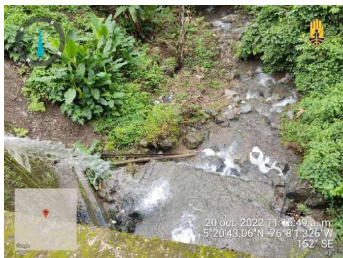
Foto 5. Registro fotográfico donde se evidencia estructura hidráulica, el cual no es suficiente debido a la alta energía del drenaje.
