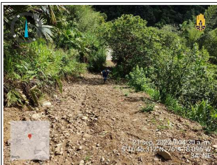
Foto 1. Evidencia de la conformacion del camino mediante maquinaria amarilla con una pendiente alta.
