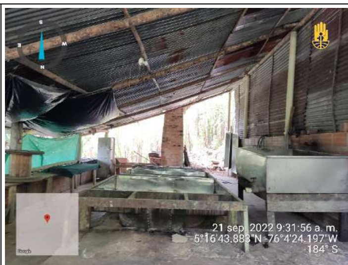
Foto 2. Estado de la estrucutura del trapiche de la finca la floresta.
