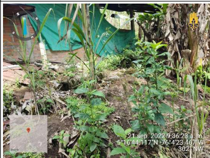
Foto 4. Erosion hidrica producto de las aguas lluvias que caen directamente del techo del trapiche.
