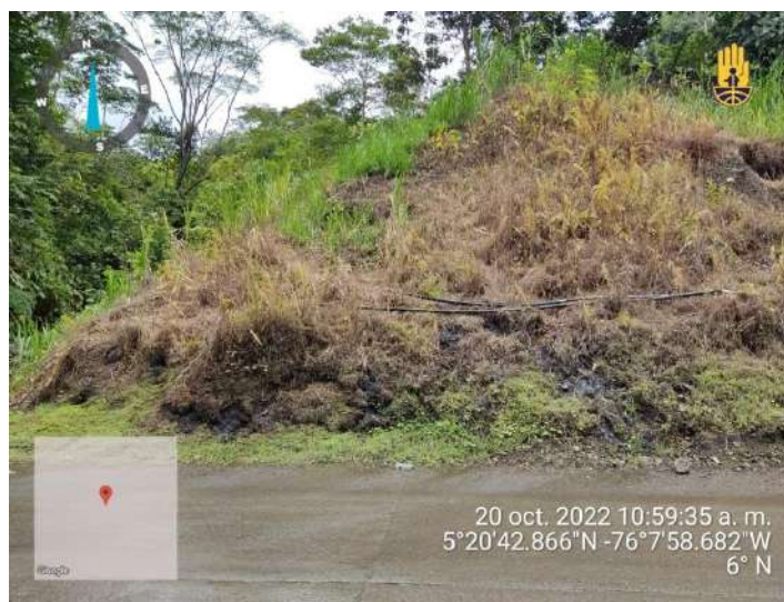
Foto 1. Registro fotográfico donde se evidencia deslizamiento tipo rotacional.
