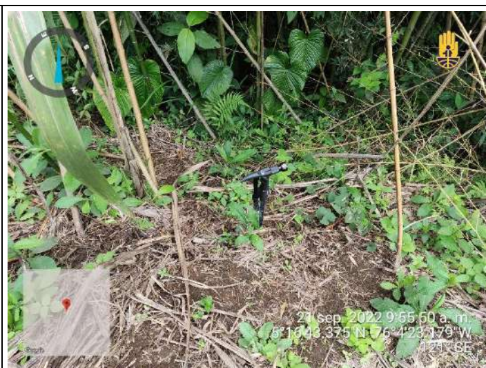
Foto 6. Registro de otra grieta, la profundidad de esta es mayor el baston para senderimos se hunde 1 metro aprox.
