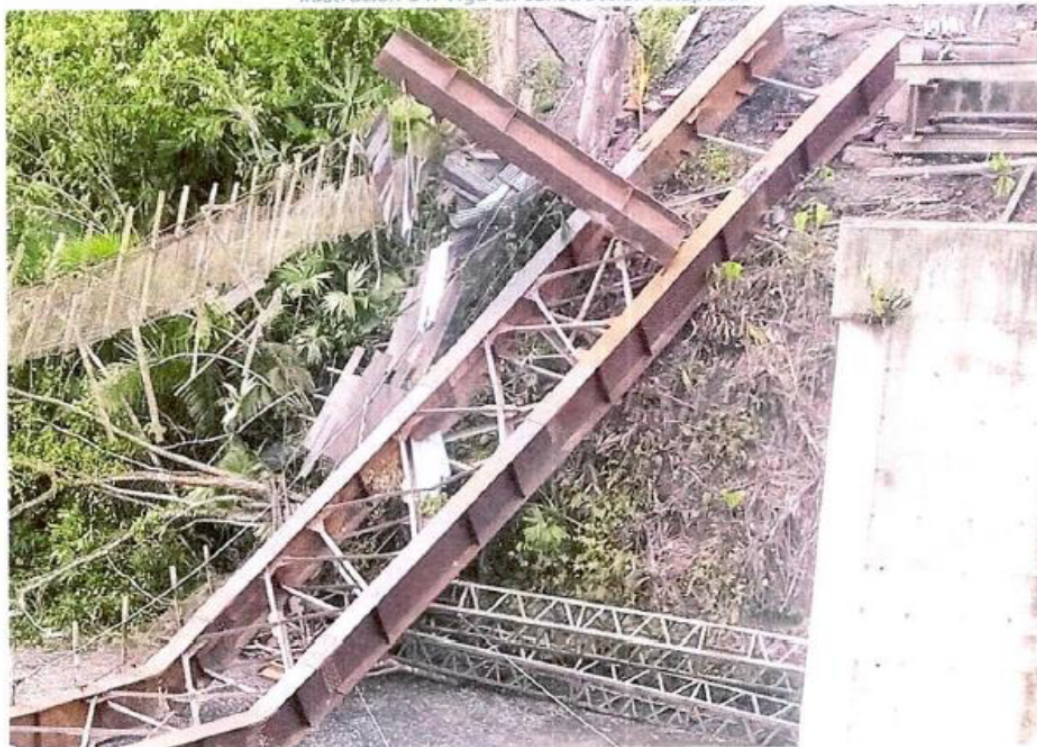
Ilustración 14: Viga en construcción colapsada
