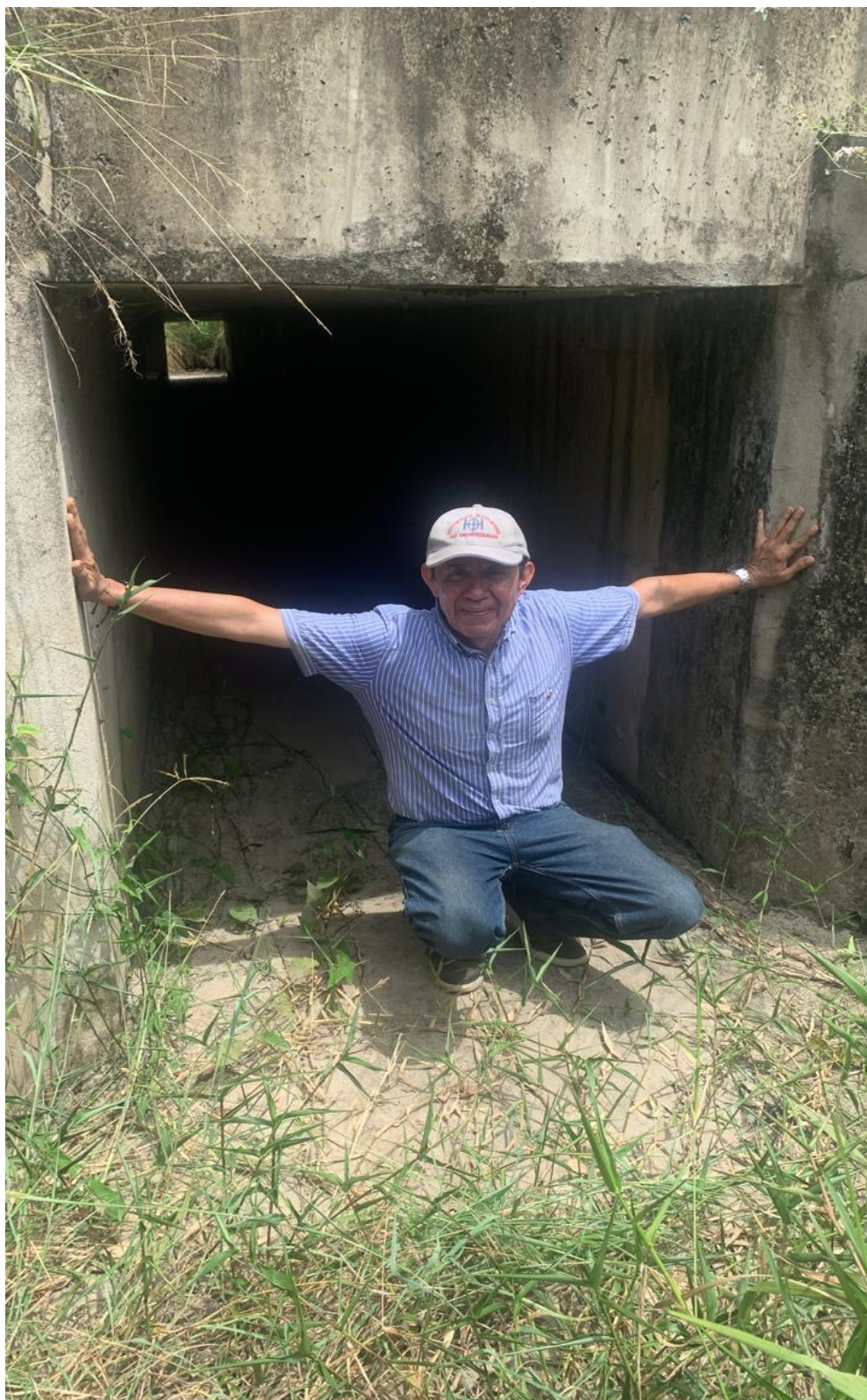
FOTO 14: ALCANTARILLA TIPO BOX CON BUENA SECCION
