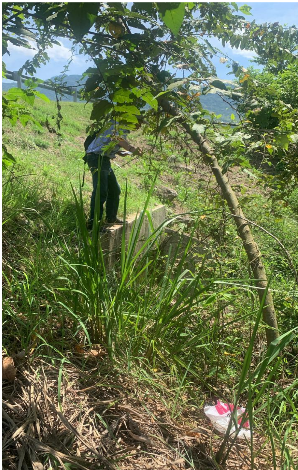
FOTO 8: ALCANTARILLA TIPO BOX PARA RECOGER LAS AGUAS DE LOS PREDIOS GIBRALTAT I Y II
