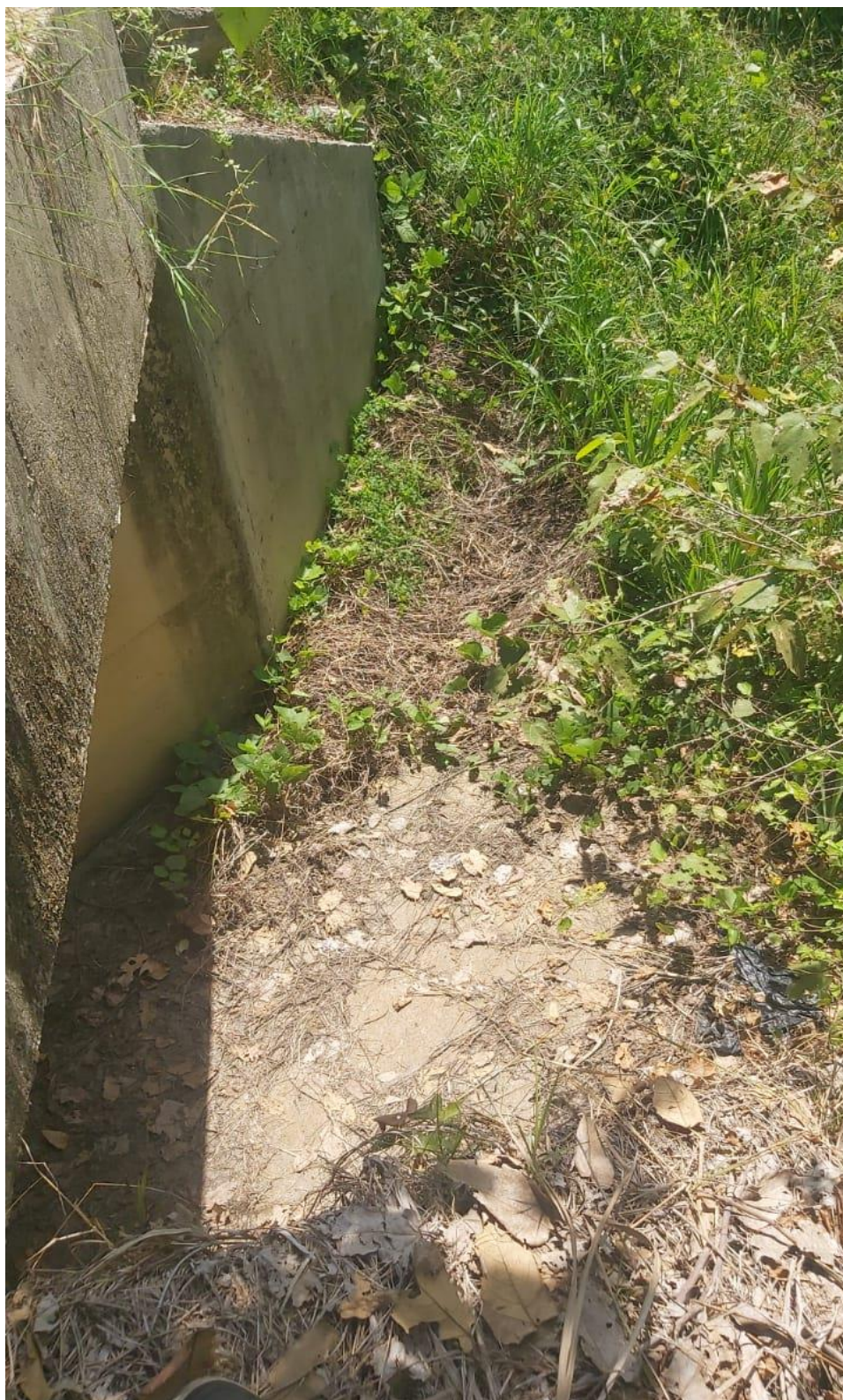
FOTO: 16: DESNIVEL DE ENTRADA DEL AGUA A LA ALCANTARILLA
