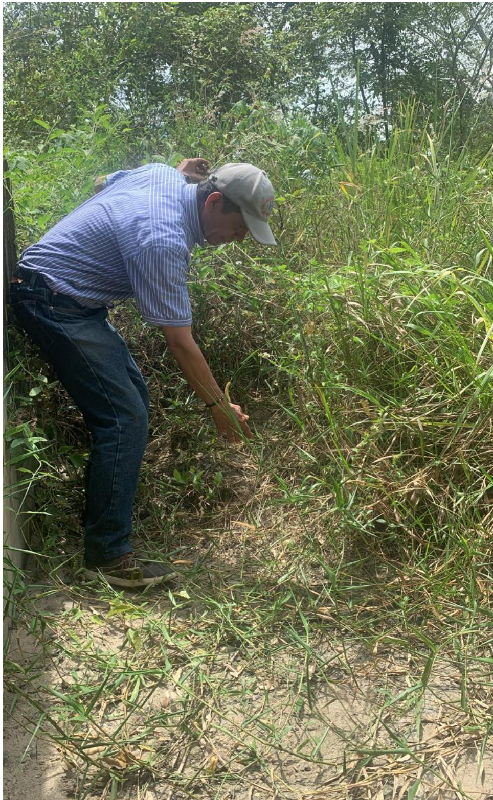
FOTO 15: MONTE O HIERBA EN EL ENCOLE DE LA ALCANTARILLA
