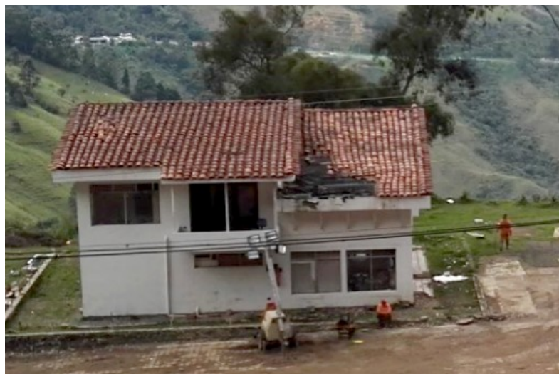
Vivienda cuya cubierta resultó también parcialmente afectada
