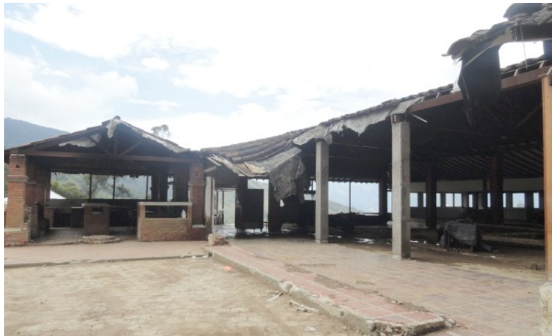
El inmueble en donde funcionó anteriormente un restaurante, resultó afectado parcialmente por el deslizamiento
