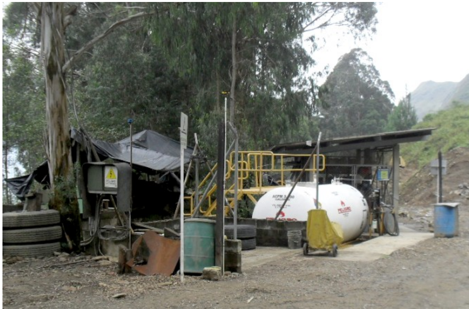
Tanque de combustible con capacidad para 3.000 galones de ACPM y talleres de mantenimiento
