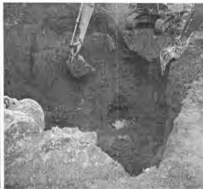
IMAGEN 04: SE OBSERVA IMAGEN DE LA PROFUNDIDA DE LA ESCABACION EN DONDE SACARON A LAS VICTIMAS DEL HECHO OCURRIDO.
