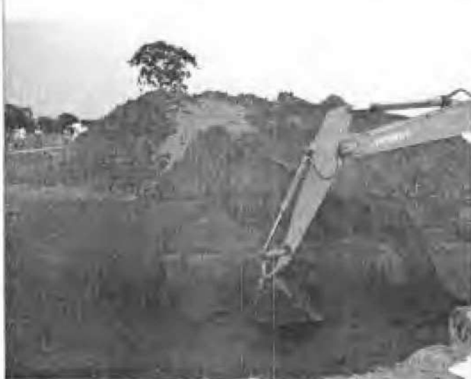
IMAGEN 06 SE OBSERVA RETRO ESCABADORA COLOR NARANJA MARCA HITACHI 200, DE IGUAL FORMA SE OBSERVA PARTE EN DONDE OCURRIO EL DERUMBE DE LA ESCABACION.
