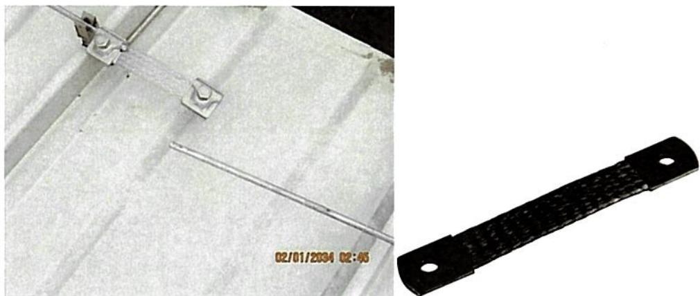
Fig6 Dilatación del aluminio y sistema de aterrizar estructuras, marca Propster Ref 1376
