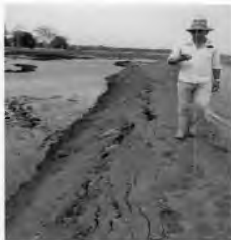
Foto:25.-Vista fracturamiento de talud retenedor de lodos de la celda 1
