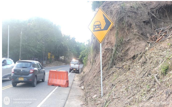
PR10+983BG, PR11+291BG Sector El Paso, SP42 Señalización preventiva, zona derrumbe.
