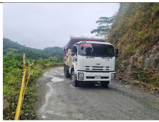
Ancho Calzada insuficiente para dos vehículos en sitio del accidente Ausencia de barreras viales o defensas metálicas
