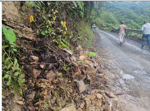
K44+806 Se evidencia que la zona es inestable y se presentan constantes deslizamientos que por la inclinación del talud, cualquier desprendimiento caería directamente sobre la calzada que de por si no supera los 4.80m
