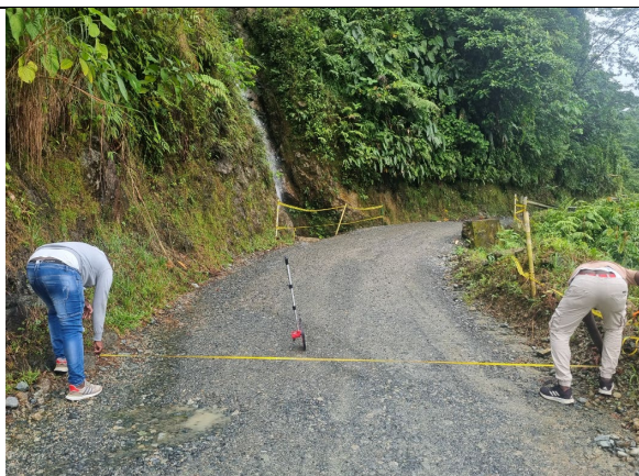
K44+600 Se evidencia estrangulamiento de la calzada a 5m
