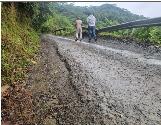
Irregularidad en la calzada, se aprecia que se ha subsanado parcialmente con concreto instalado, pero por la falta de drenaje y el inadecuado manejo de escorrenías la calzada presenta gran deterioro en la superficie.
