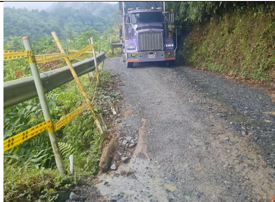
K44+674 Se evidencia calzada de 3.3 m, con pérdida de banca y elementos como troncos de madera para suplir la falta de sección de la vía, elementos que claramente no cumplen con las especificaciones de una vía nacional y generan una probabilidad de riesgo de accidente.
