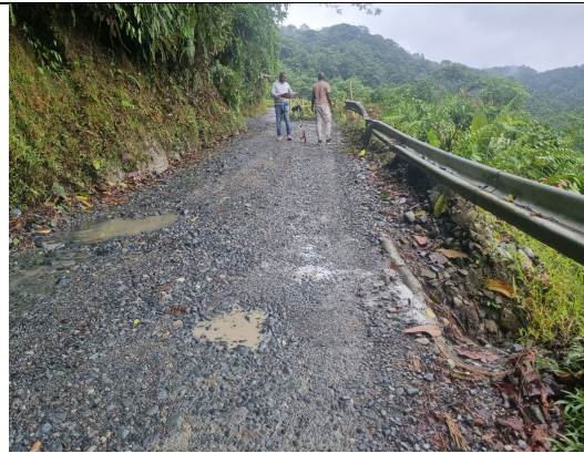
K44+634 Se evidencia estrangulamiento de la calzada a 3,5m por pérdida de calzada, en tramo recto, igualmente se evidencia inicio de barrera metálica en mal estado que no contine captafaros.
