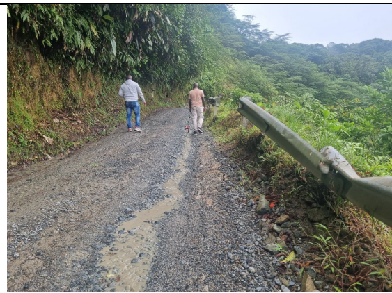
Se aprecia Defensa metálica deteriorada, sin elementos reflectivos como captafaros que permitan durante la noche alertar a los usuarios sobre los límites de la calzada.
