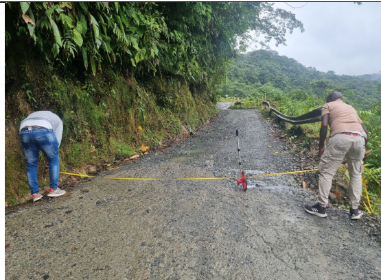
K44+634 Se evidencia estrangulamiento de la calzada a 3,5m por pérdida de calzada, en tramo recto, igualmente se evidencia inicio de barrera metálica en mal estado que no contine captafaros.
