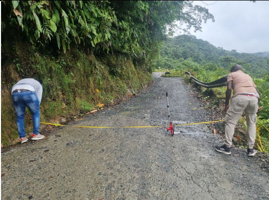
K44+634 Se evidencia calzada de 3,5m por pérdida de calzada, en tramo recto, igualmente se evidencia inicio de barrera metálica en mal estado que no contine captafaros.
