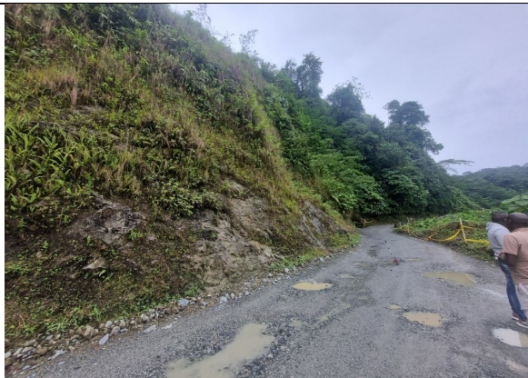
Ampliación talud izquierdo sentido Quibdó-Medellín Aun así la calzada en este punto tiene un ancho insuficiente y que no cumple con las medidas reglamentarias.
