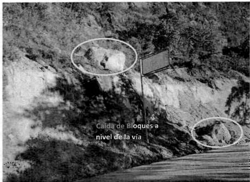
Fotografía 2. Caída de bloques a nivel de la vía Fuente: Propia Agosto 2013
