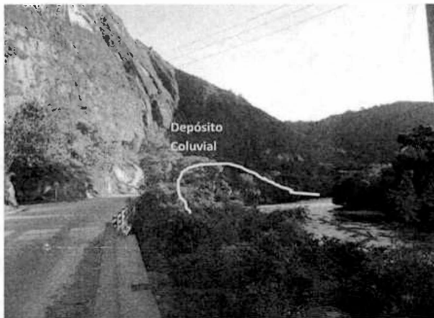
Fotografía 5. Zona con inestabilidad en la banca de la vía Fuente: Propia Agosto 2013
